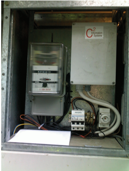
KUVIO 14. Valmiiksi asennettu ohjausyksikkö
