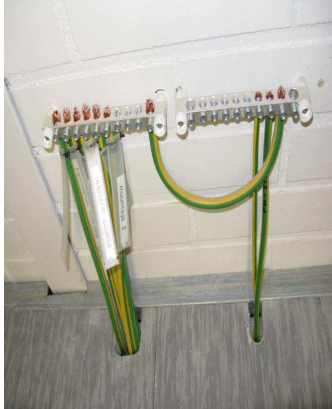
Kuva 16. Esimerkki muuntamon päämaadoituskiskosta
