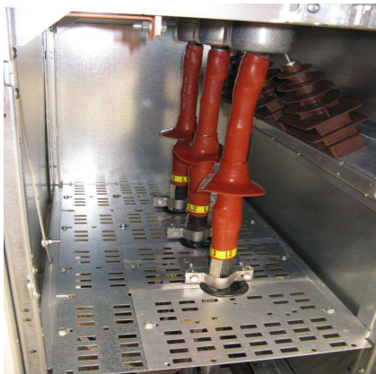
Kuva 19. Enston 20 kV:n sisäpäätteet
