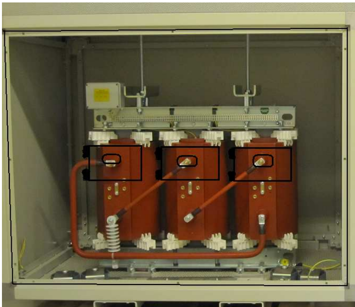
Kuva 24. Pleksin aukot jännitteen koettamista ja työmaadoitusta varten
