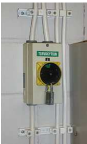
Kuva 20. Pääkytkin, jossa on lukitusmahdollisuus.
