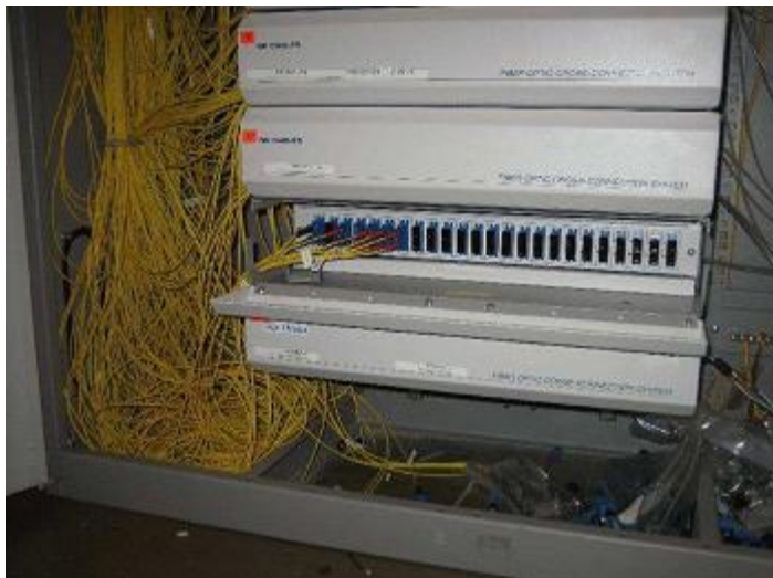
Kuva 10. Yleiskuvaa paneeleista ja kytkentäkuiduista.
