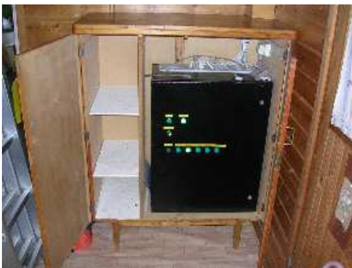
Kuva 31. Kiinteistön ohjauskeskus toiminnassa.
