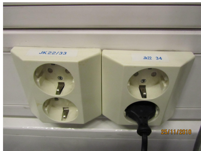
Kuva 19. Pistorasioista vastaavat sähkökeskusten ja sulakkeiden numerot
