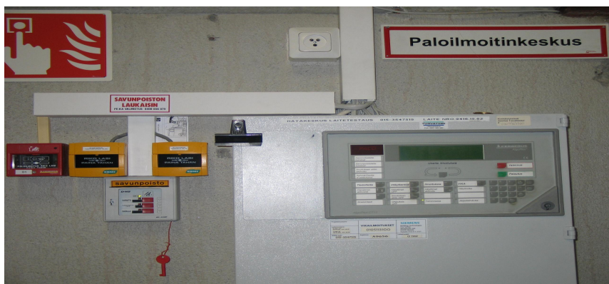
KUVA 9. Paloilmoitinkeskus (Etelä-Savon pelastuslaitos A).
