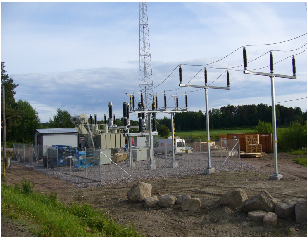
KUVA 1. Loviisa 110/22 kV sähköasema.
