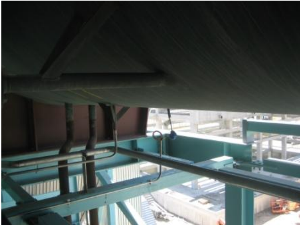
Kuva 11. Syöttovesisäiliön lämpötilalähetin. Epäonnistunut yhteen sijoitus. Valokuva Janne Immonen.
