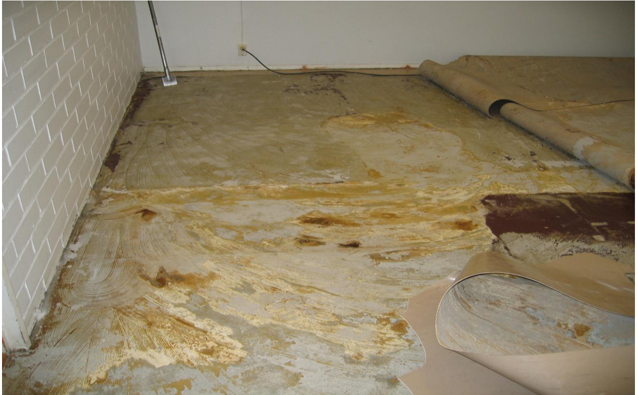
Kuva 3. Maanvaraisen lattian lattiapäällysteen vaurioituminen kuva Markku Miettinen
