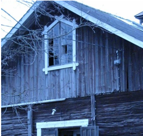
Kuva 26. Vanhan tallin ruutuikkuna on yksityiskohta, joka vaatii korjausta.
