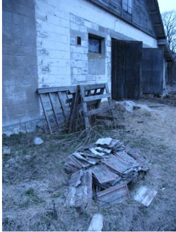
Kuva 23. Meijerin edustalle on jäänyt rakennusmateriaalia.
