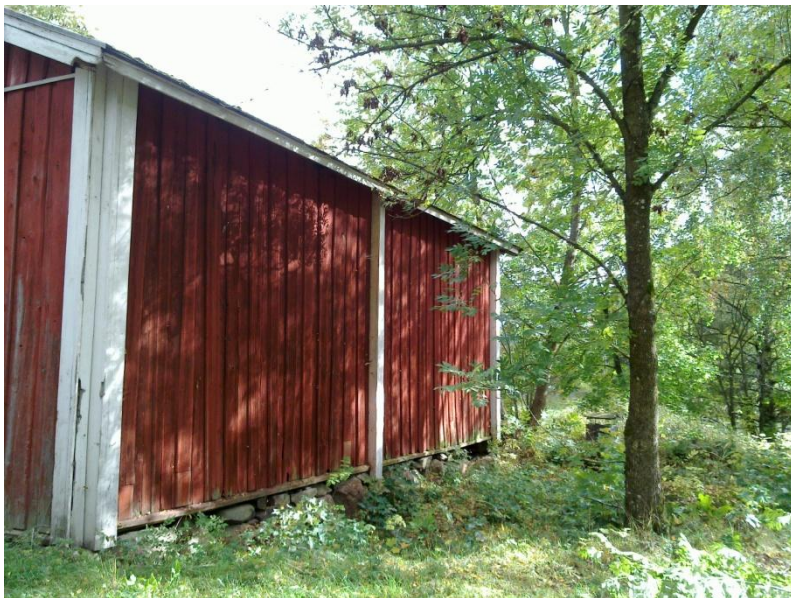
Kuva 18: Runsas puusto eristää riihen pois maisemasta. Etualalla oleva saarni tulee kaataa tai sen oksia karsia, jottei oksisto vaurioita rakennusta.
