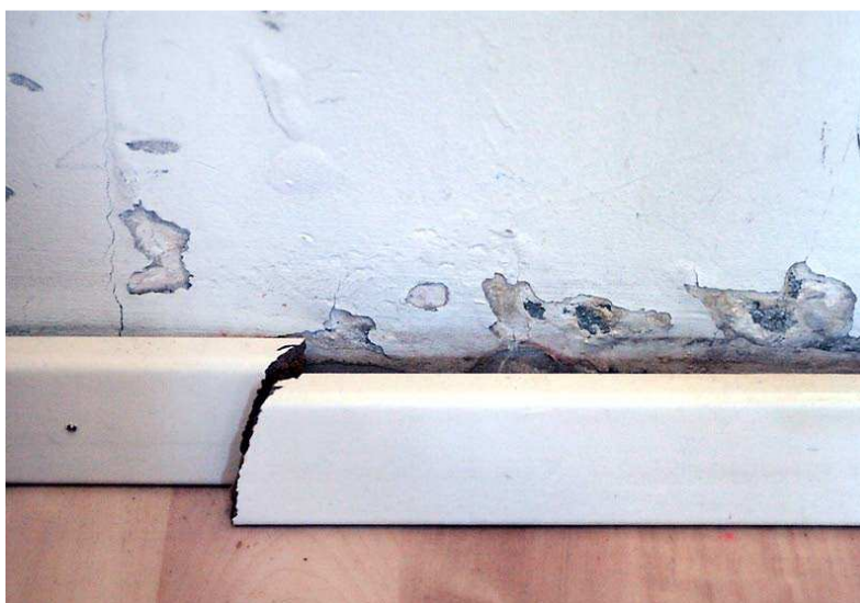
Figur 9: Fuktskadad vägg. På andra sidan väggen ligger ett badrum som saknar fuktspärr (Eerola, 2009).
