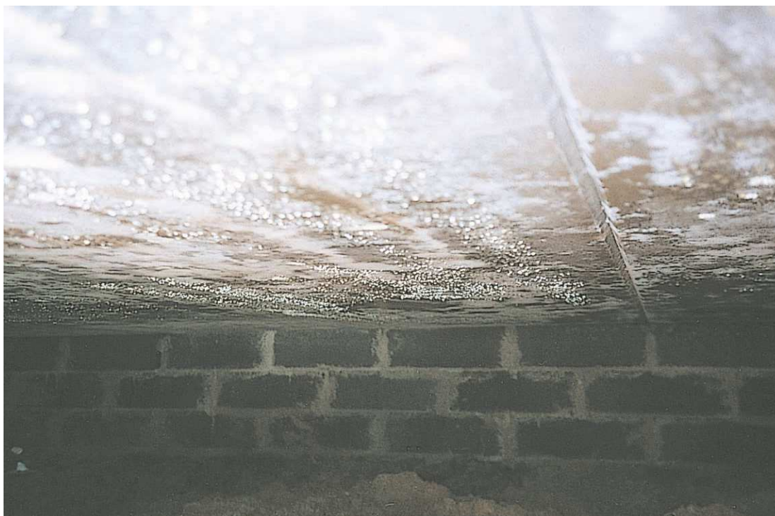
Figur 13: Kondens på undersidan av ett bottenbjälklag i en krypgrund (RT 05-10710).
