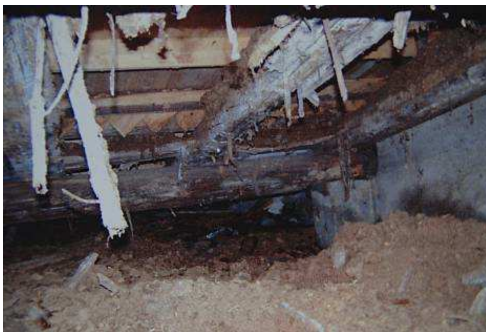
Figur 11: Fuktskadat bottenbjälklag (Saastamoinen, K. 2009)
