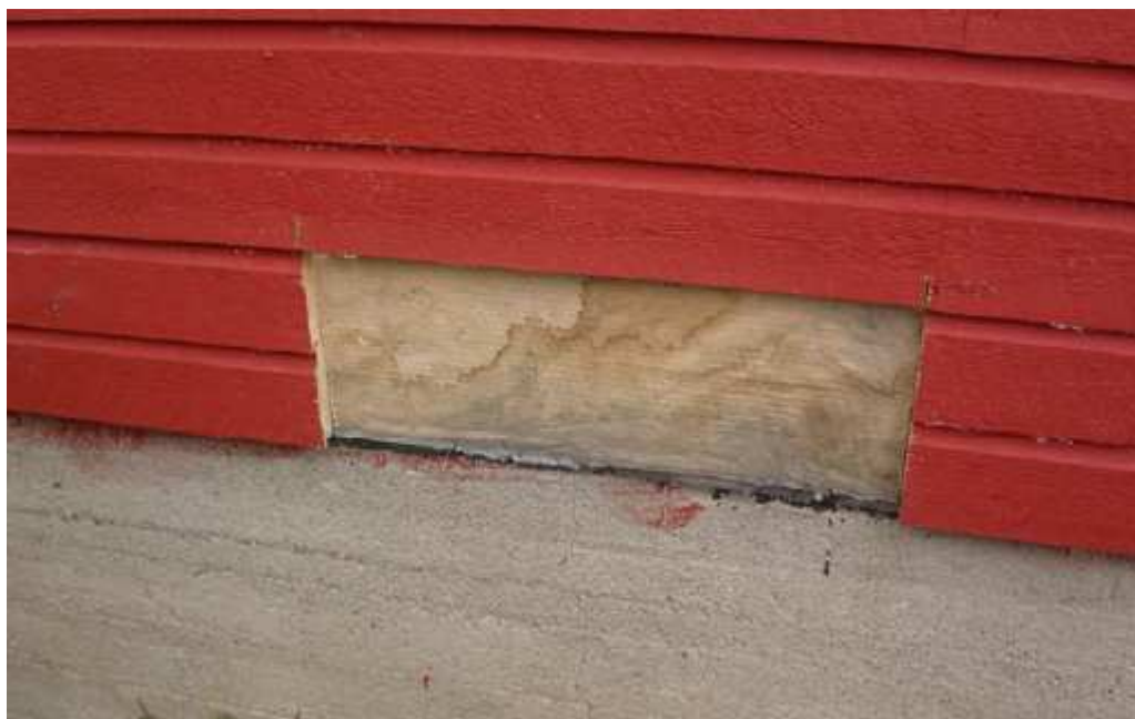
Figur 10: Öppning i yttervägg där det inte har gjorts en luftspalt bakom brädfodringen (Karjalainen, J, Riippa, T, 2010).
