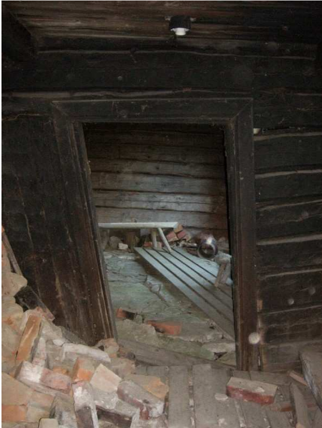
KUVA 3. Näkymä löylytilasta pesutilaan, vasemmalla romahtanut piippu ja sen voimasta työntynyt seinärakenne.
