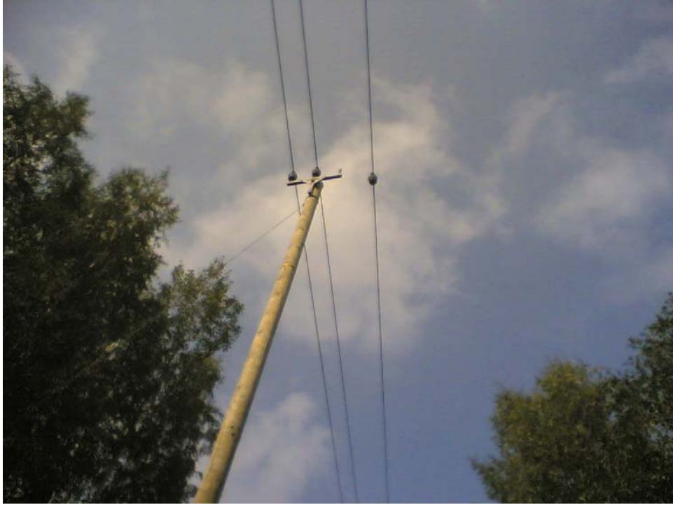
KUVA 4. Eristimiseen pylväältä irronnut PAS-johdin.
