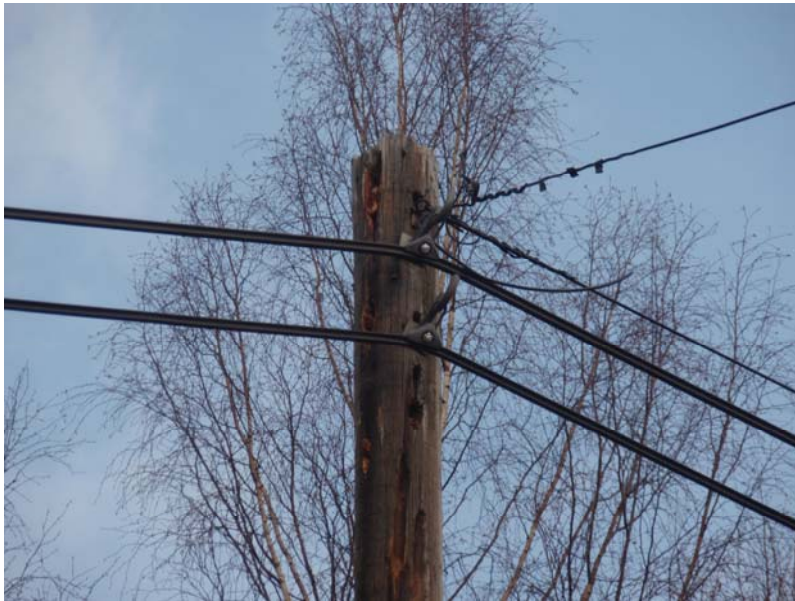
KUVA 3. Lahoamisen vaikutuksia pylvään yläpäässä. (Inspecta Oy)
