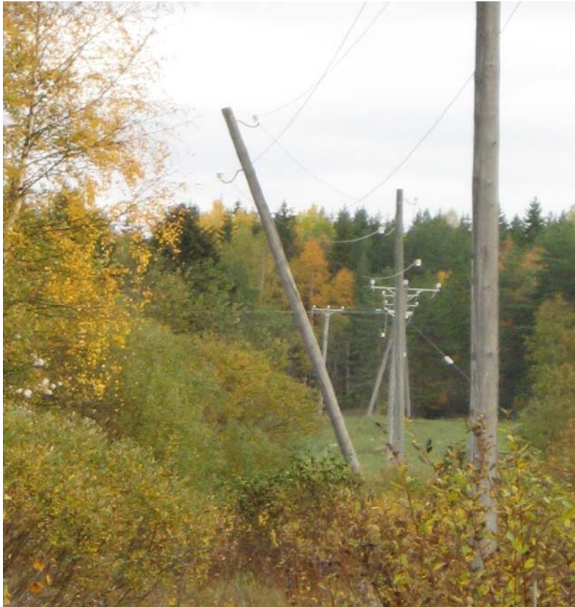
KUVA 1. Kallistunut pylväs (Inspecta Oy)
