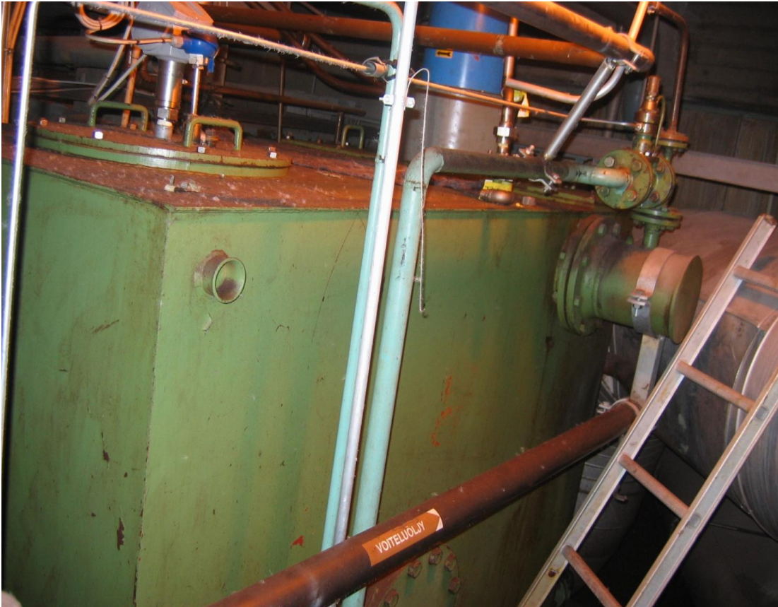
KUVA 10. Öljysäiliö. Kuva Joni Makkonen
