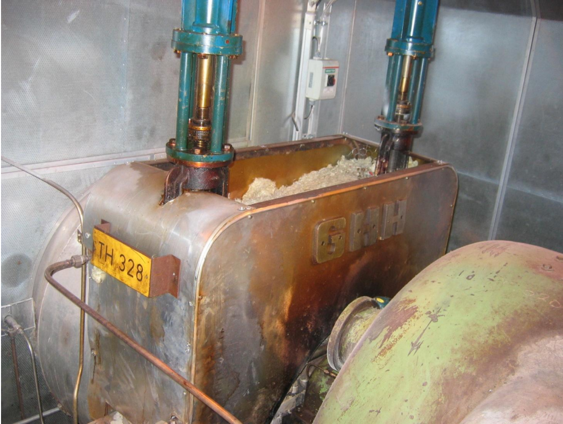
KUVA 16. Jäämäkaasuturbiini ja solaventtiilit. Kuva Joni Makkonen
