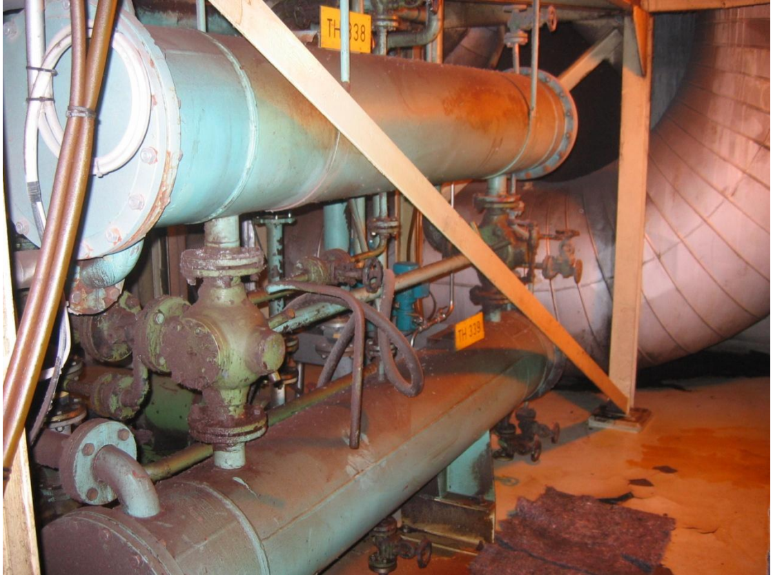
KUVA 11. Öljynlämmönvaihtimet. Kuva Joni Makkonen
