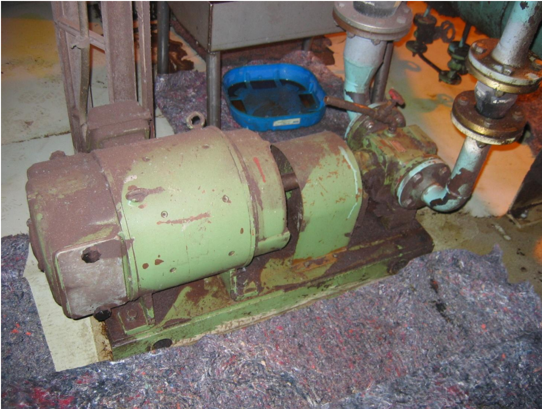
KUVA 7. Hätäöljypumppu ja akkukäyttöinen sähkömoottori. Kuva Joni Makkonen
