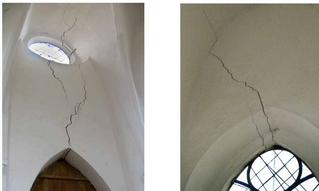
KUVIO 17. Halkeamia sisäseinissä: oven yläpuolella ja pyöröikkunan ympärillä sekä sivuikkunan yläpuolella
