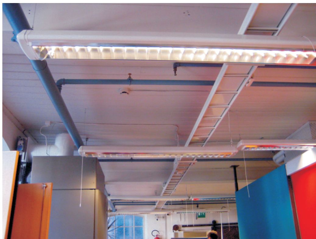
Bild 87. Elströmskena och lysrör.
