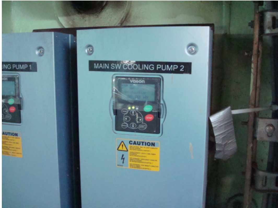
Kuva 11. Pääkoneen merivesipumppujen taajuusmuuttajat
