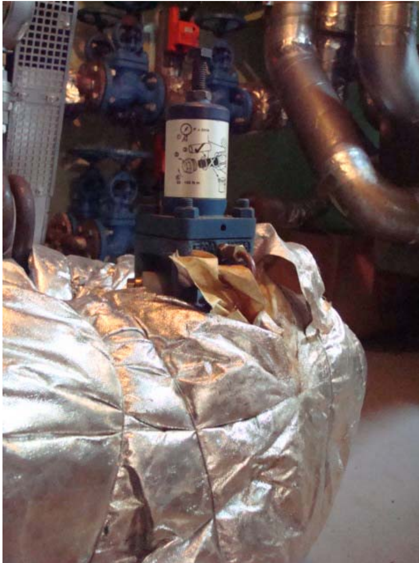
Kuva 13. Futuralle asennettu ilmastoinnin lämmityshöyryn paineenalennusventtiili
