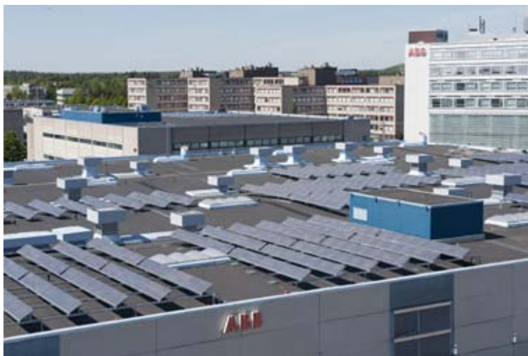
Kuva 1. Aurinkovoimala Helsingin Pitäjänmäellä (kuva ABB)
