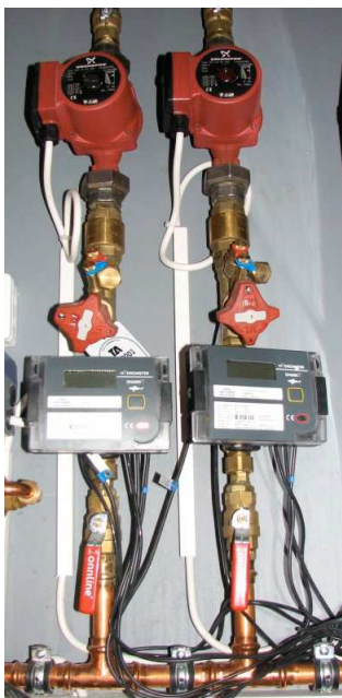
Kuva 21. Lämpöenergiamittarit sekä järjestelmän kiertovesipumput.
