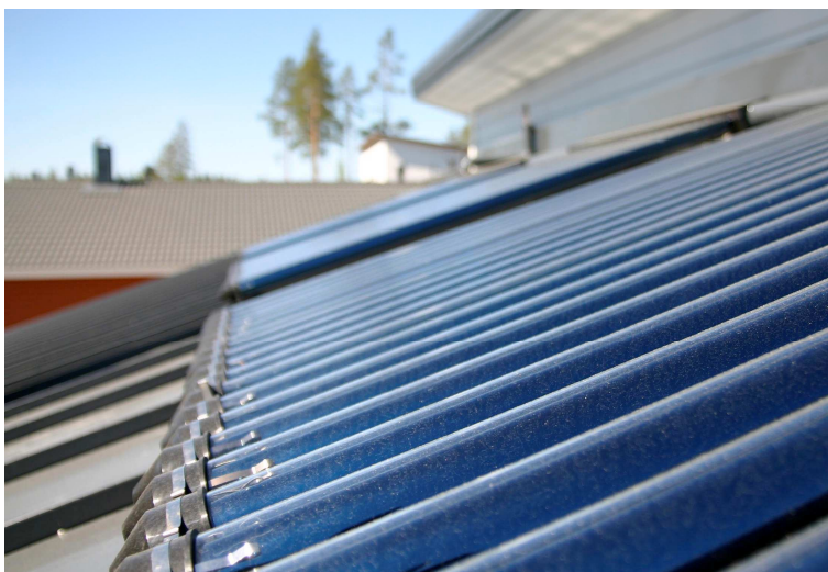
Kuva 15. Parha-talon katolla olevat tyhjiöputkikeräimet. (Arvinen, 2010).
