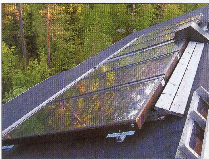
Kuva 14. Katolle asennettu tasokeräin. (Leppänen, 2004, 20).
