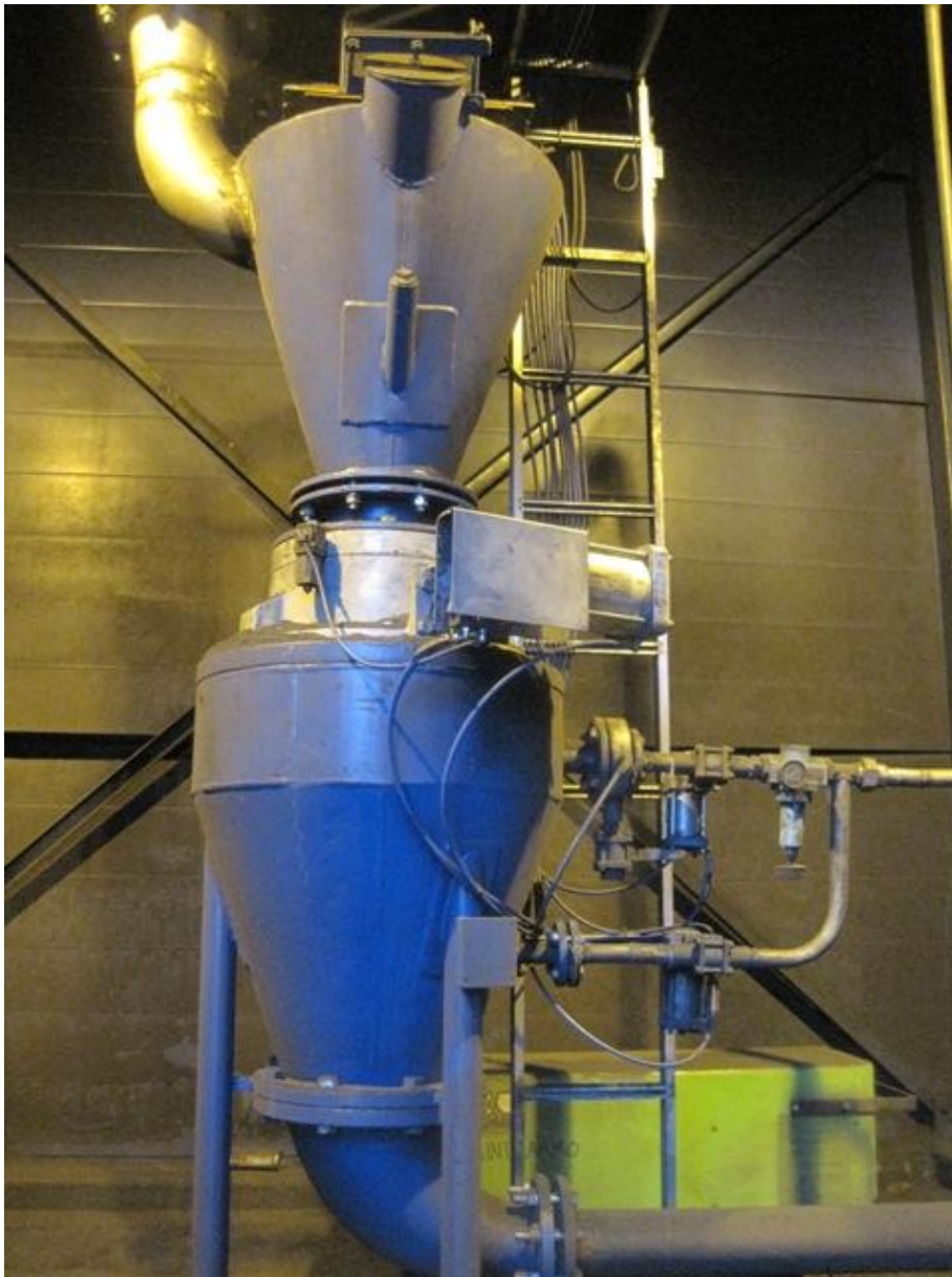
Kuva 13. Pölynpoiston pneumaattinen kuljetin asennettuna
