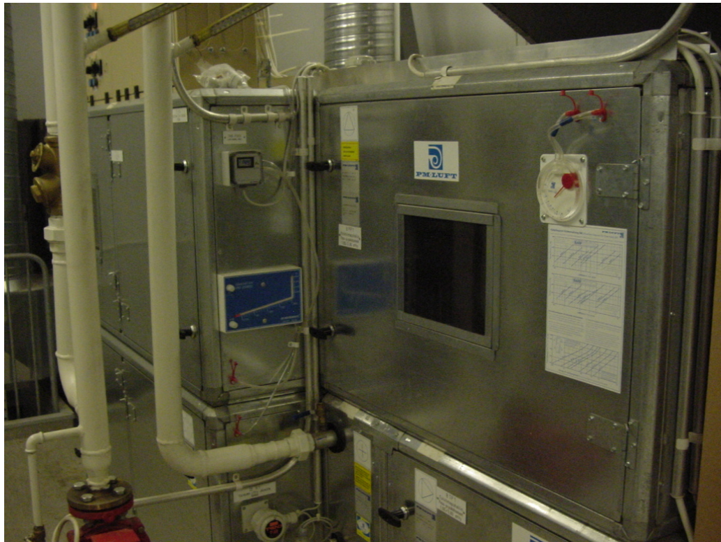
KUVA 4: Ilmankäsittelykone, jossa digitaalisia ilmanpaine- ja lämpötila-antureita sekä osoittavia painemittareita.
