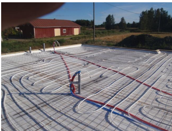
Kuvio 4. Lattialämmitysputkisto omakotitalossa. (Miika Oksanen 2010)
