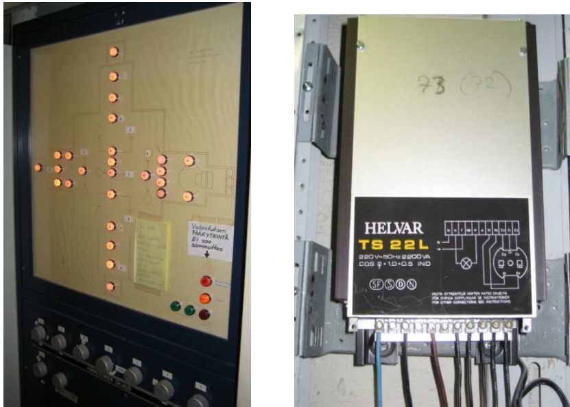
KUVA 18. Valaisinohjaustaulu ja himmennin
