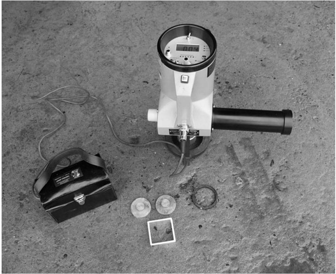
Kuva 2. Tartuntavetolaite Easy-M, akku, vetolaippoja ja eristyksen reunojen leikkausohjaimia. (Sillan vedeneristystyömaan laadunmittaus © Liikennevirasto 2009.)
