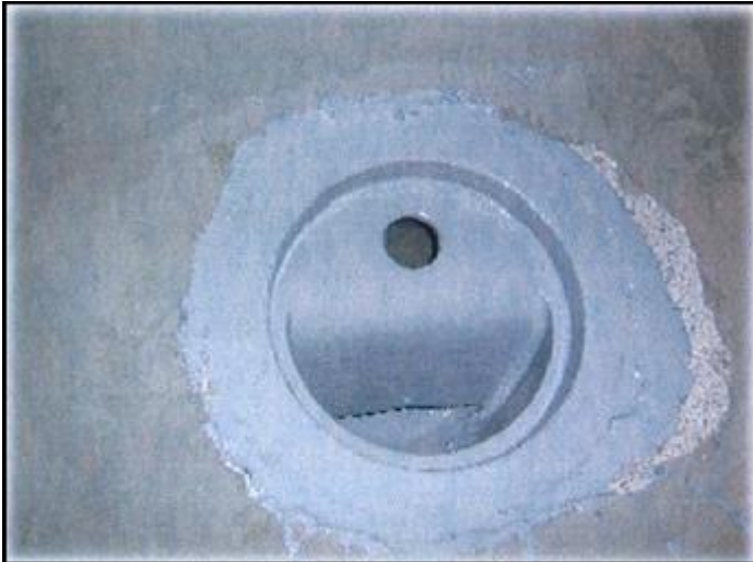
Kuva 29. Kertaalleen pinnoitettu lattiakaivo (Raatikainen 2011).
