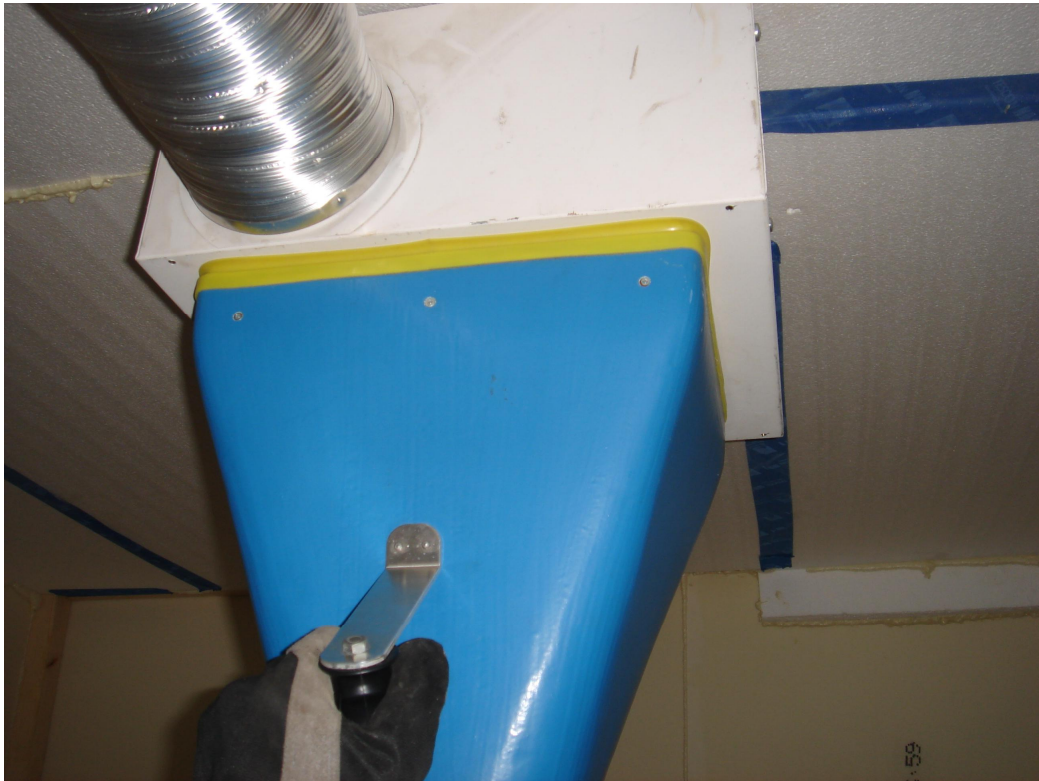
Kuva 25. Poistopuhaltimen ilmamäärän mittaus.
