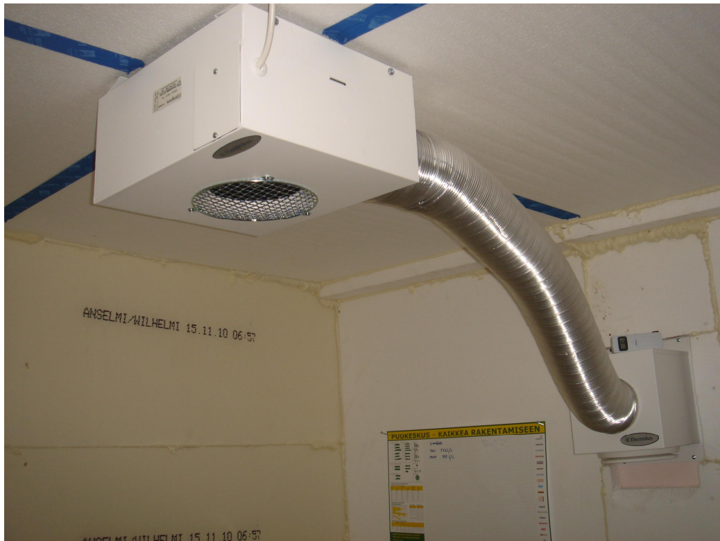
Kuva 21. Vanha järjestelmä asennettuna demonstrointitilaan.
