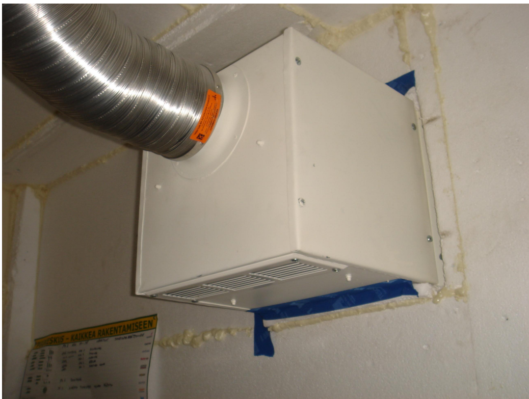
Kuva 22. Lämmöntalteenotto asennettuna demonstrointitilaan
