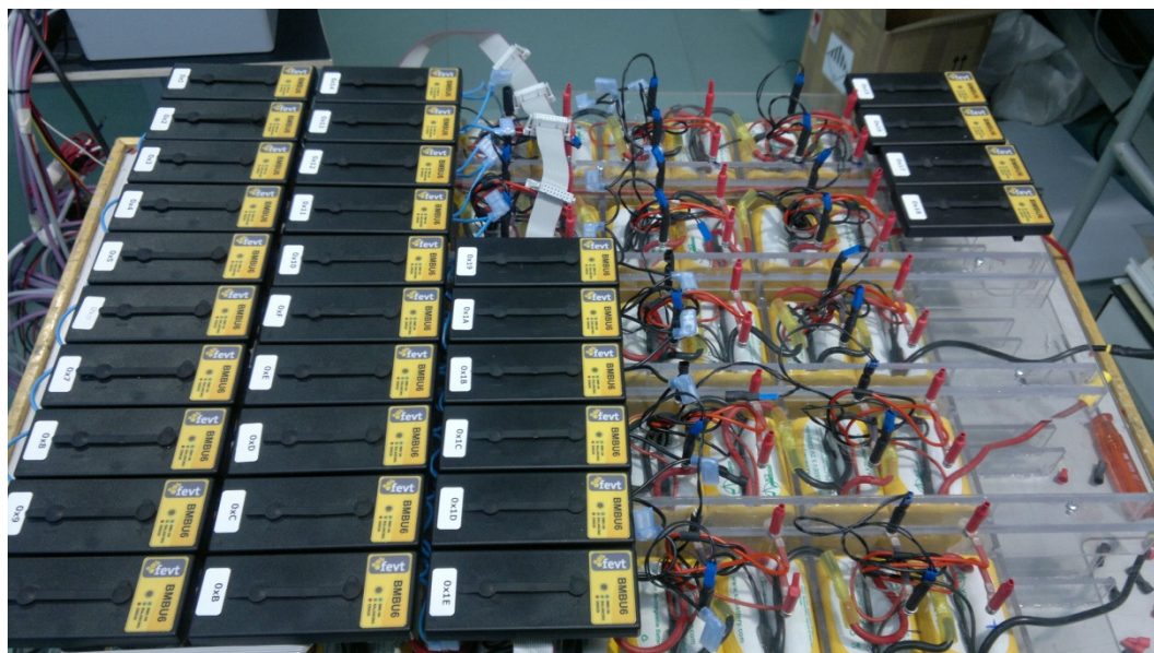
Kuva 7. BMBU6 -yksiköiden kytkentä.
