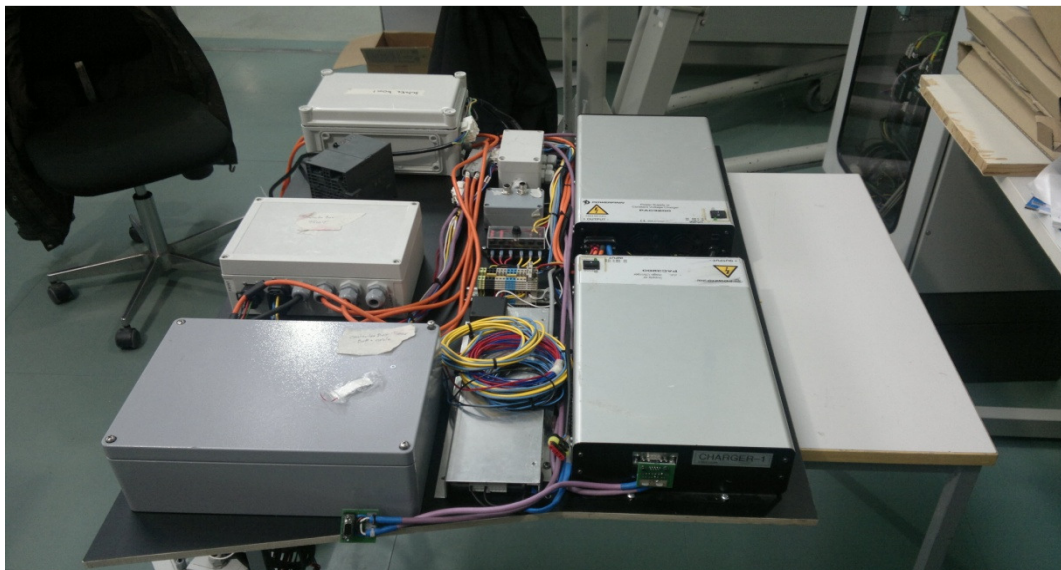
Kuva 1. Etu- ja takakontaktorimoduulit , varaajamoduuli ja DC/DC muuntimet.
