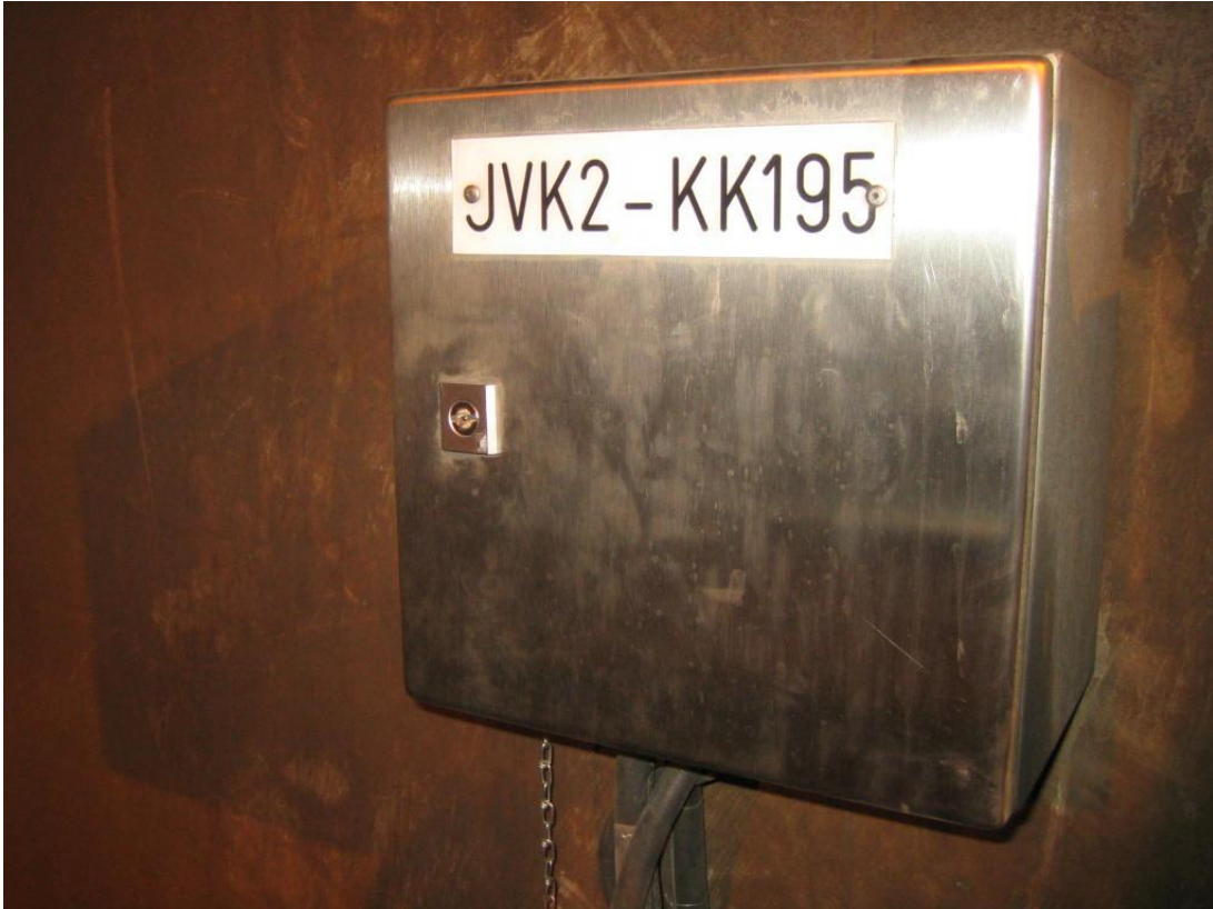
Kuva 11. Pyrometriä suojeleva sähkökaappi
