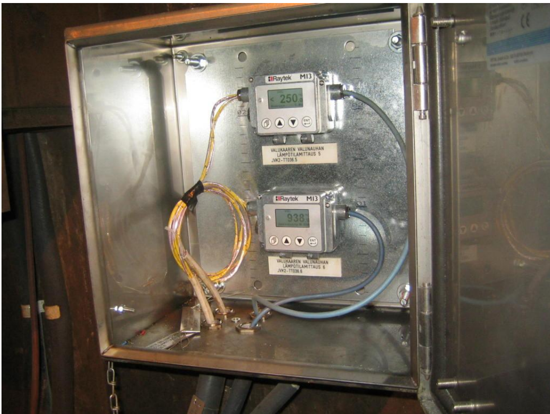
Kuva 12. Pyrometrien asennus pareittain
