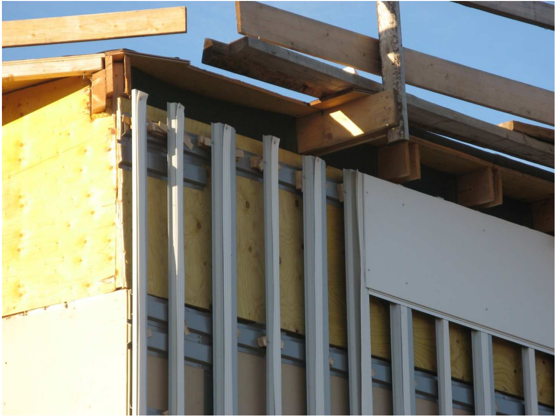
Kuva 7. Jotta valmiista pinnasta saadaan suora, täytyy pystyrankojen alle laittaa esimerkiksi vanerilappuja. Tässä työssä menee paljon aikaa. Kuva Iiro Mutanen 2010.
