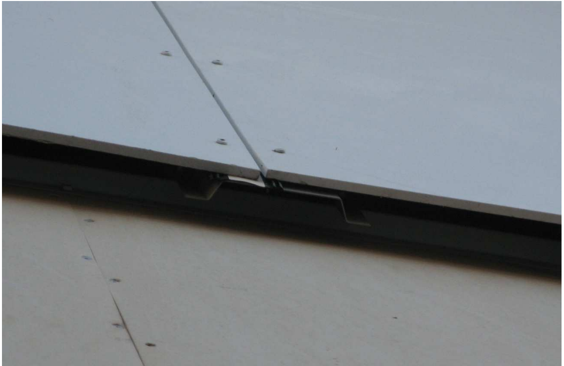
Kuva 11. Levyjen välisessä saumassa on usean millimetrin pykälä, koska EPDM-nauhan toinen laita ei ole rangan ja levyn välissä. Kuva Iiro Mutanen 2010.
