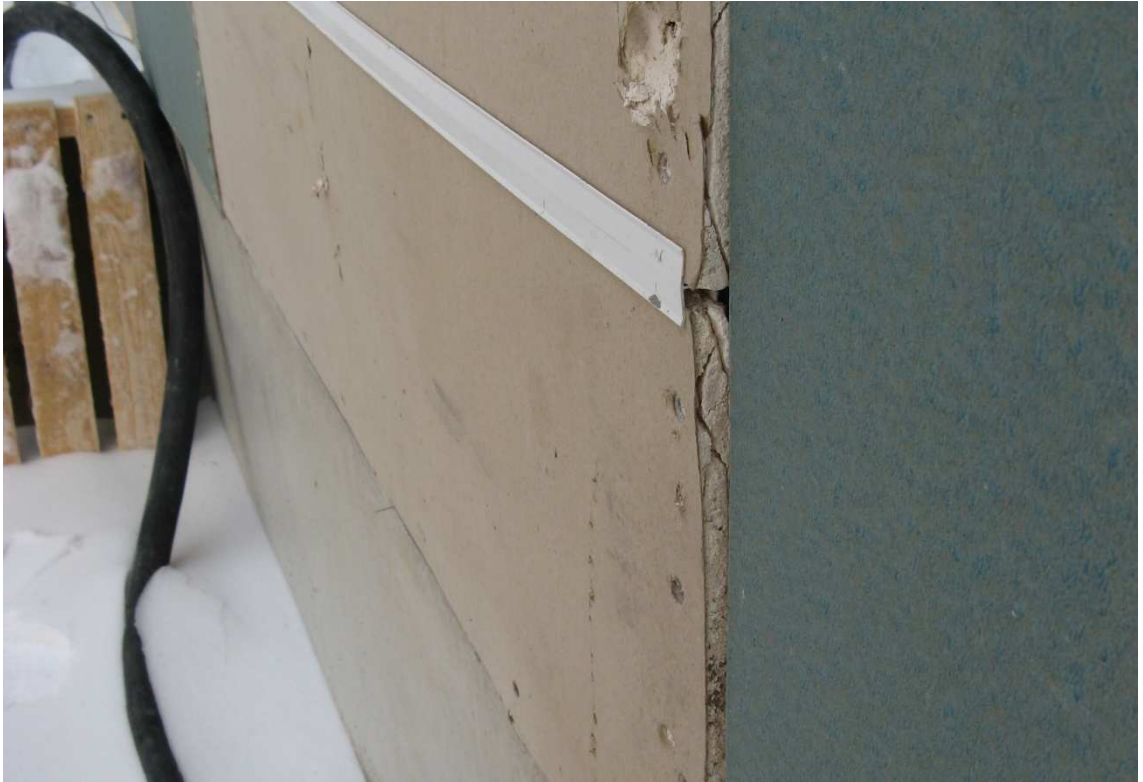
Kuva 5. Kipsinen tuulensuojalevy on kastunut ja mennyt pilalle. Kuva Iiro Mutanen 2010.
