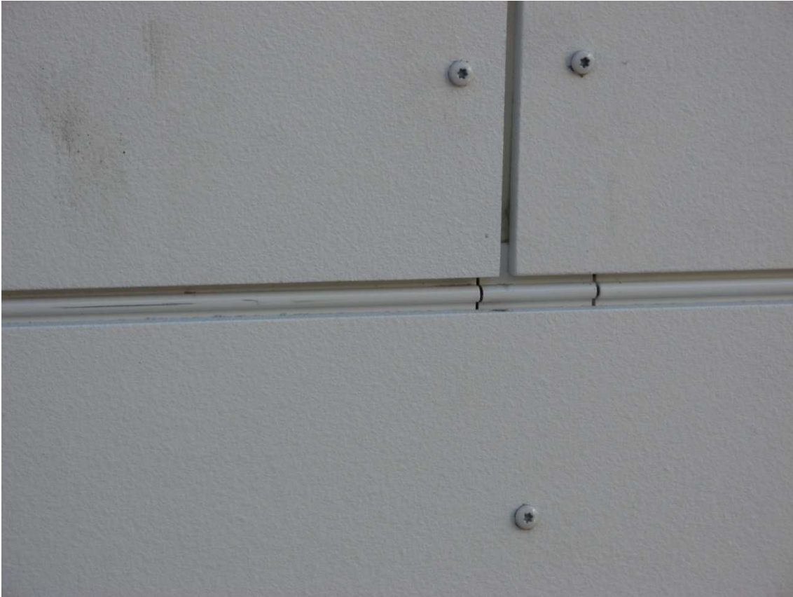
Kuva 12. Alumiininen lista levyjen vaakasaumassa estää valuvan veden tunkeutumisen levyjen taakse. Kuva Iiro Mutanen 2010.
