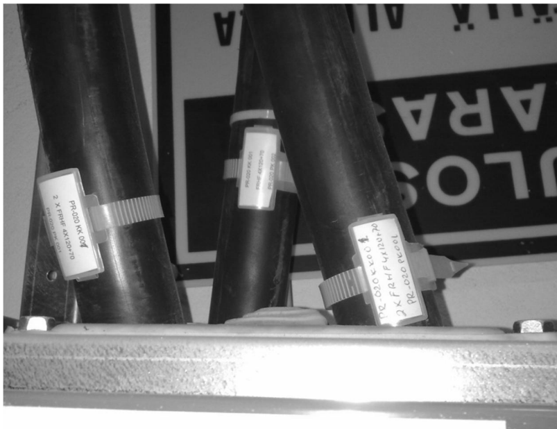
Kuva 9. Esimerkkikuva asiallisista kaapelimerkinnöistä.
