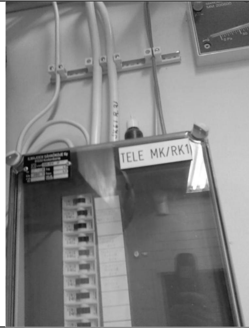
Kuva 6. Syöttö varmentamattomasta verkosta vaikka varmennettukin on.
