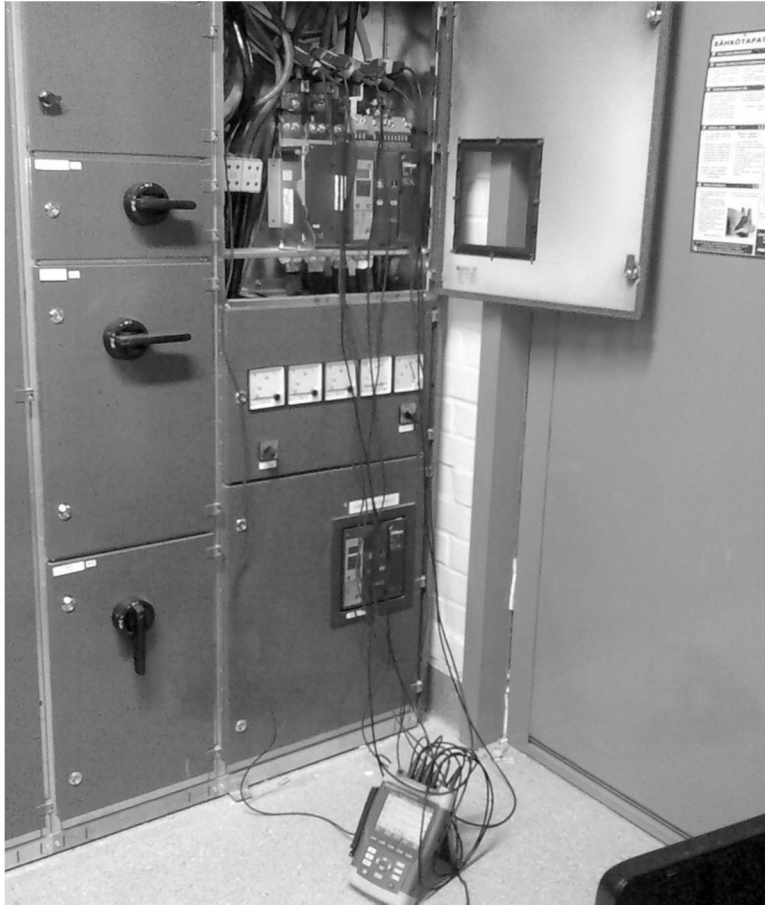
Kuva 11. Sähkölaadun analysointijärjestely eräessä kohteessa.
