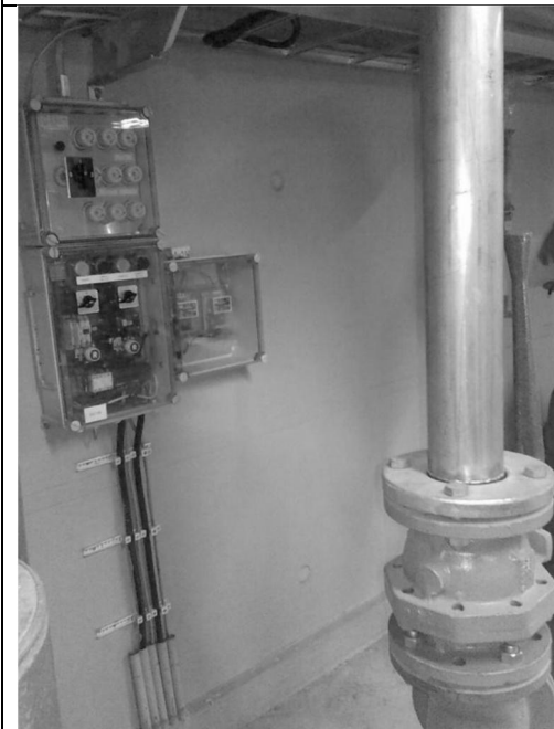
Kuva 7. Lämmityksen kojeistoja voisi olla varmennetussa verkossa.
