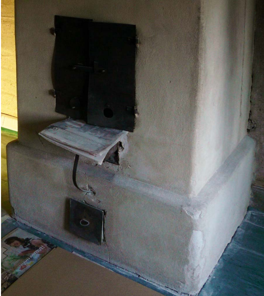
Kuva 9. Sanomalehden alla tuhkaluukun ja tulipesän välissä ei ollut enää ollenkaan rappaista.
