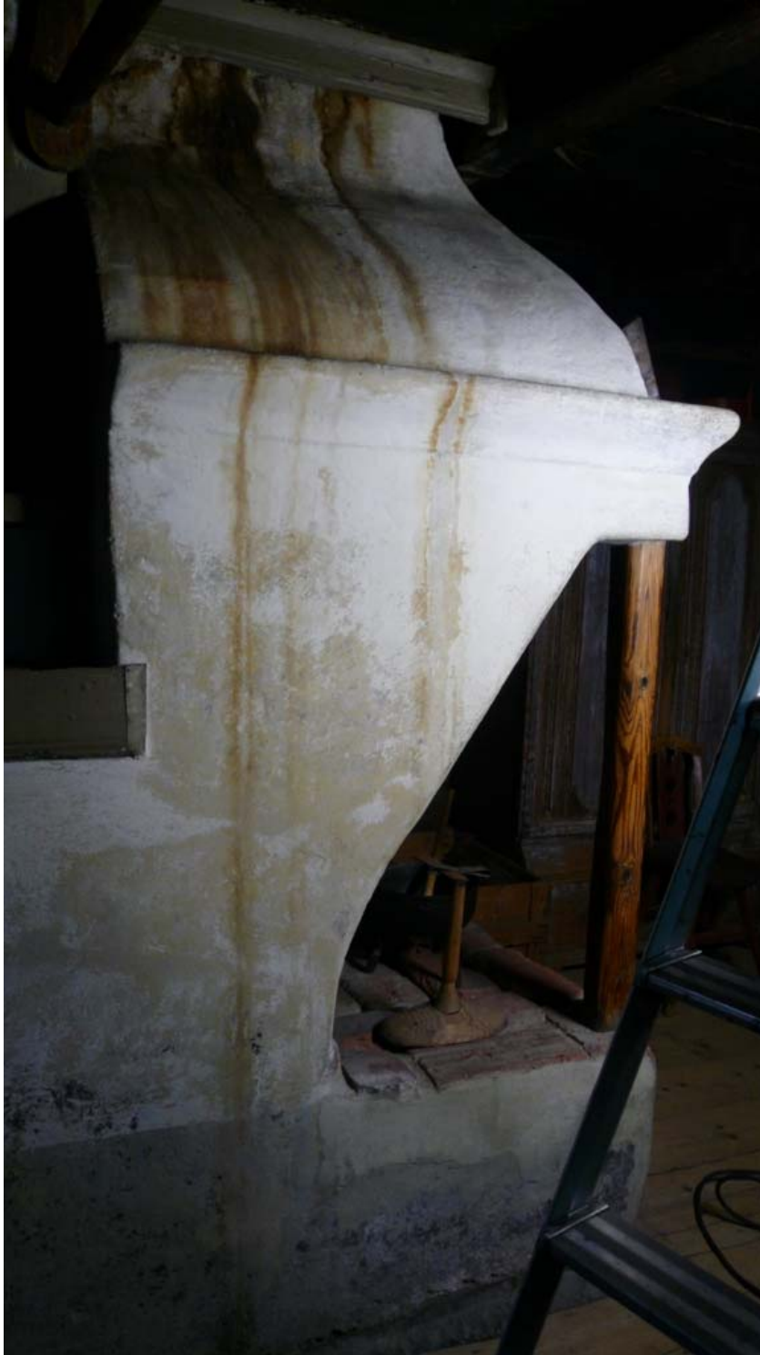
Kuva 6. Valkoisen ja harmaan värikerroksen alta näkyy alareunassa rasvaista kimröökillä värjättyä aikaisempaa pintaa ja sementillä rapattua pintaa oikealla näkyvien tiilien sivulla.
