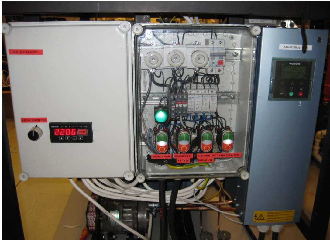
KUVA 30. Sähkökeskus ja taajuusmuuntaja
