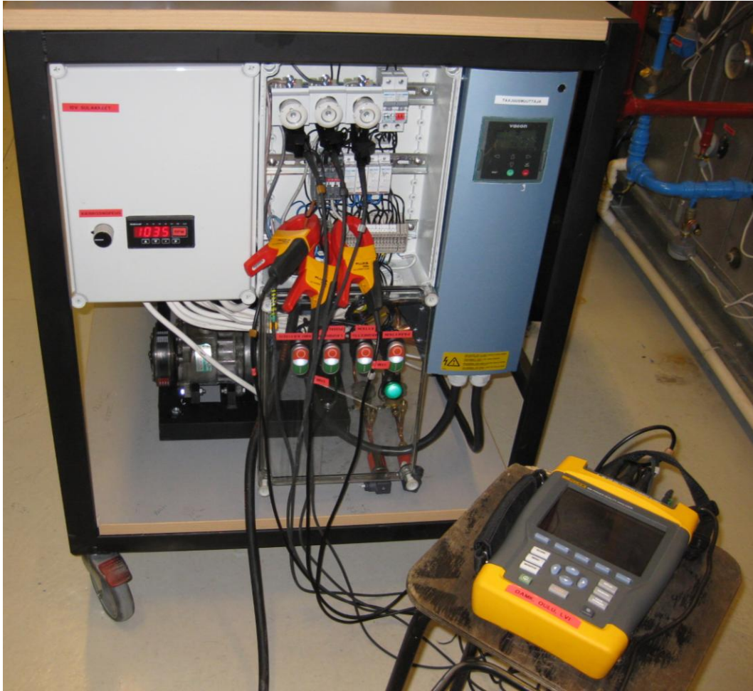
KUVA 43. Sähkömoottorin ottotehon mittaus
