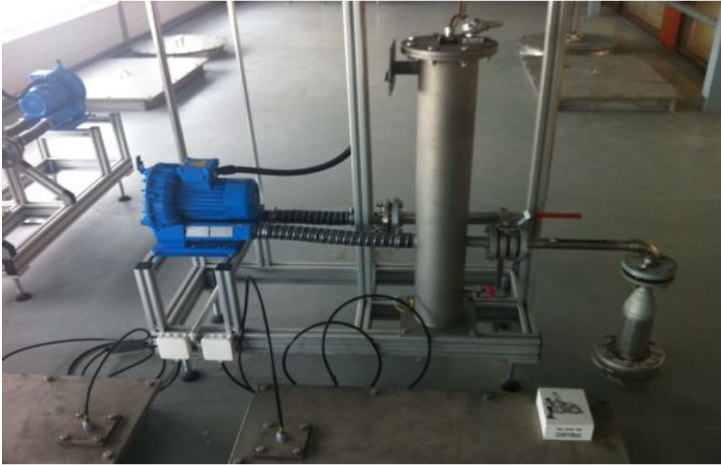
Kuva 11. Wedecon jäännösotsonin tuhoaja Viitaniemen pintavesilaitoksella
