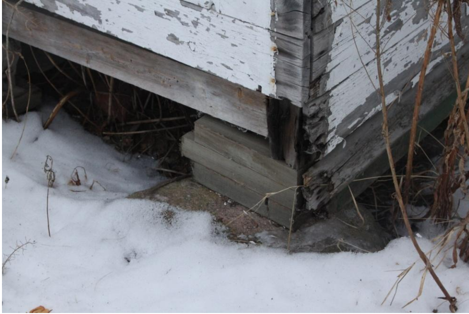
Kuva 5. Vanhan konttorin toisen sisäänkäynnin huono perustus.
