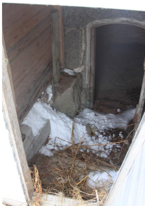
Kuva 6. Kellarin sisäänkäynnin kulunut perustus.
