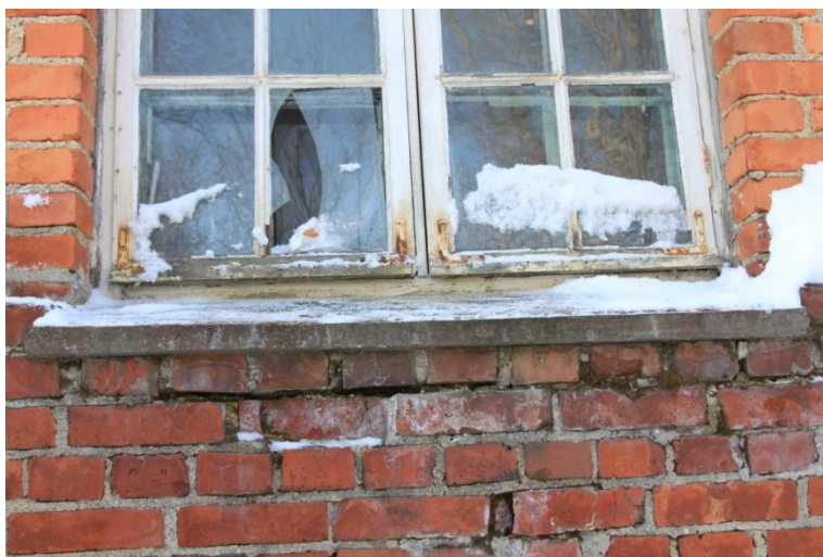
Kuva 26. Ikkunan alapuoliset vauriot.
