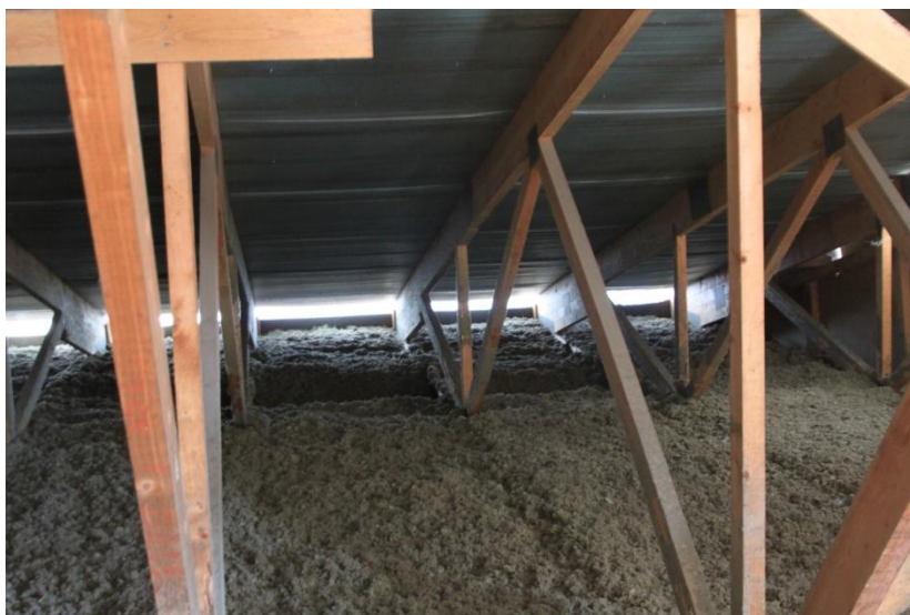
Kuva 16. Pulpperihallin yläpohjan eristyseroja.
