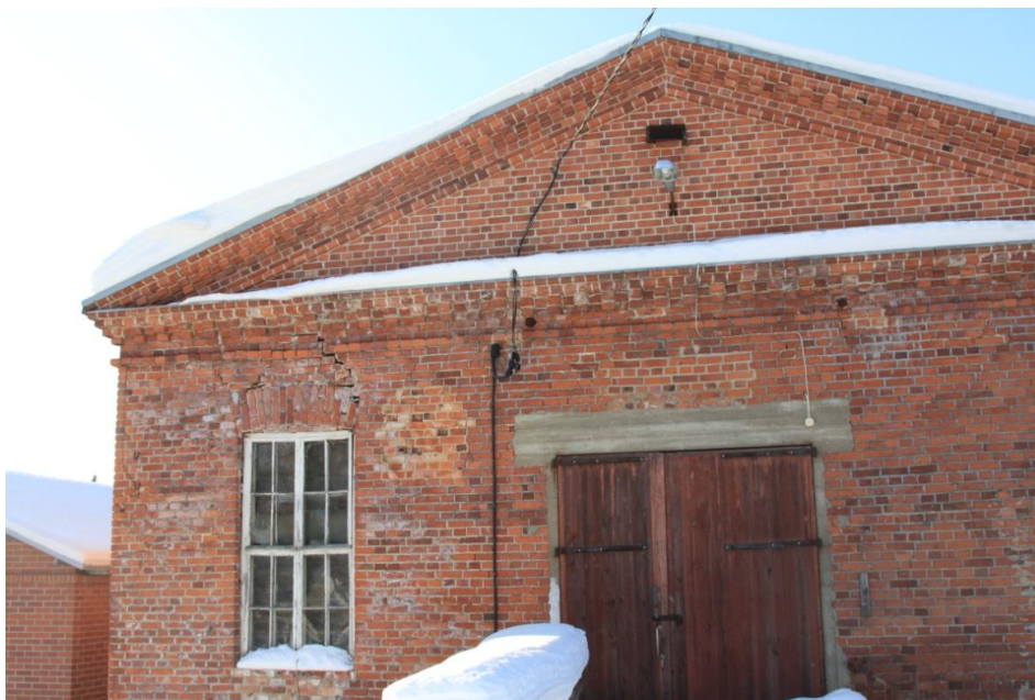
Kuva 22. Lunta kartonkitehtaan hyllykkössä ja julkisivuvaurioita.
