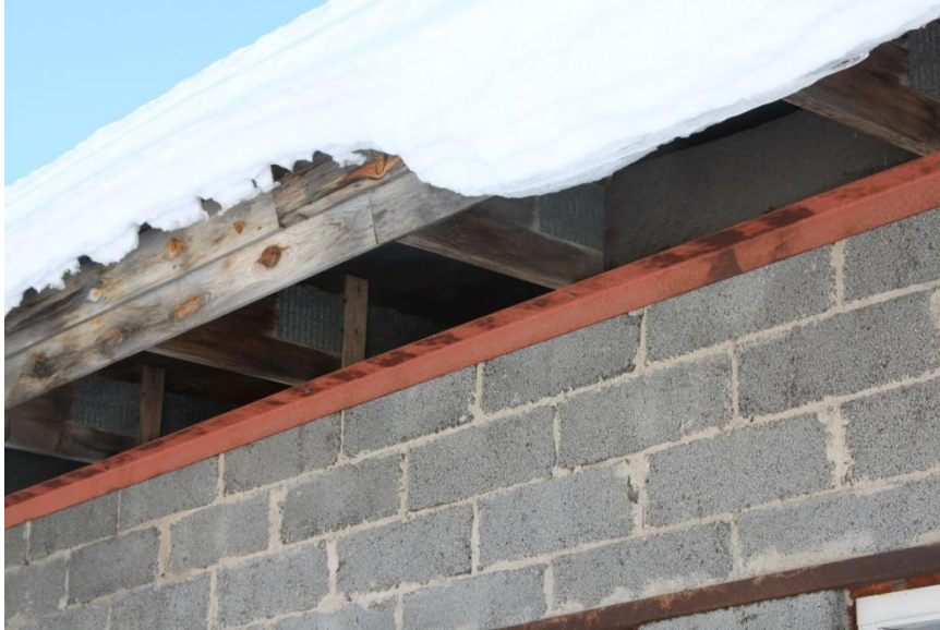
Kuva 17. Pulperihallin puuttuvat tuulensuojalevyt.
