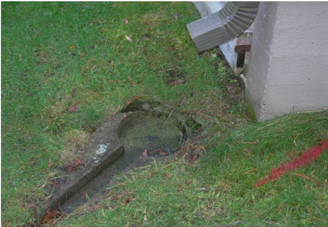
Kuvio 1. Betoninen sadevesiohjauskouru.
