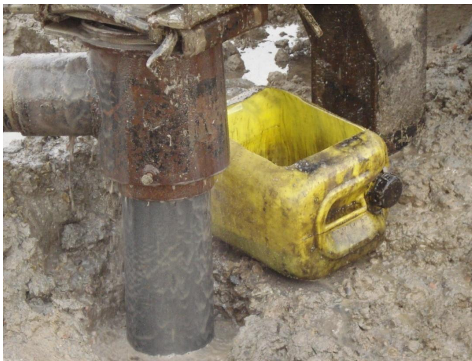
Kuva 15 Lähikuva porauslaitteesta vuotavan öljyn määrästä.
