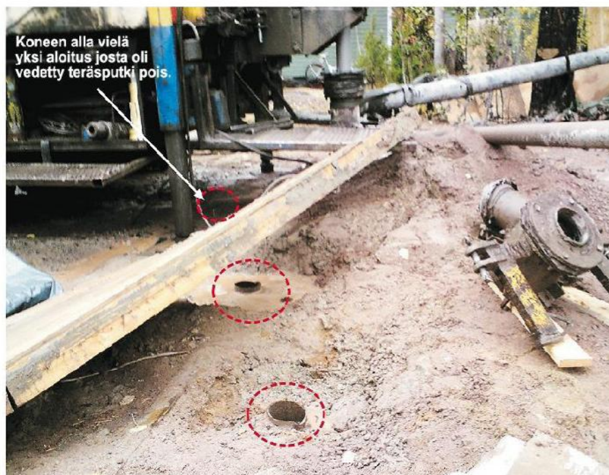
Kuva 16 Epäonnistuneita porauksia työmaalla
