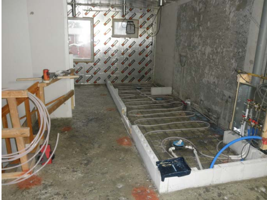
KUVA 20. Märkätilalaatan vesikiertoinen lattialämmitys
