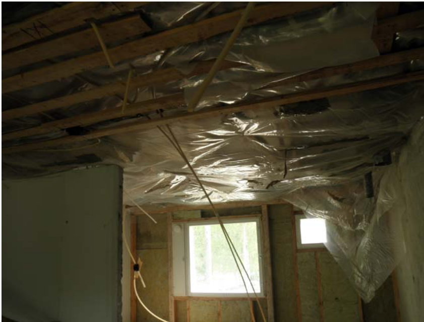
KUVA 10. Yläpohjan vuotava höyrynsulkumuovi
