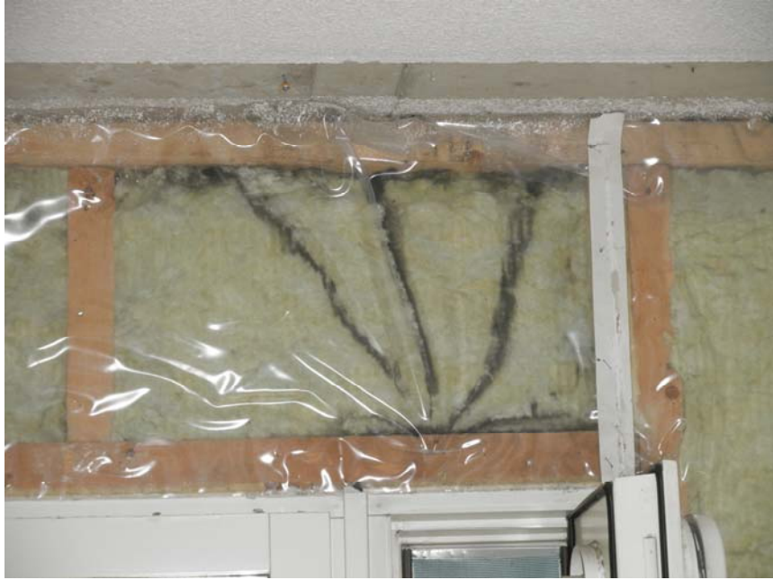
KUVA 3. Ulkoseinän tummunut lämmöneriste
