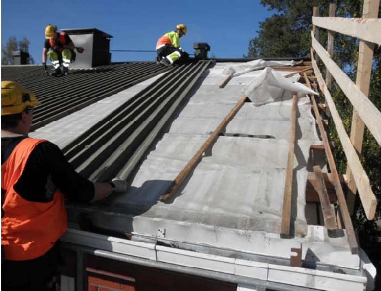
KUVA 5. Aluskatteen virheellinen asennus
