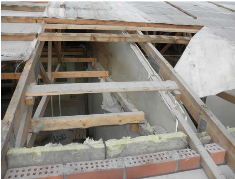
KUVA 6. Aluskatteen virheellinen asennus
