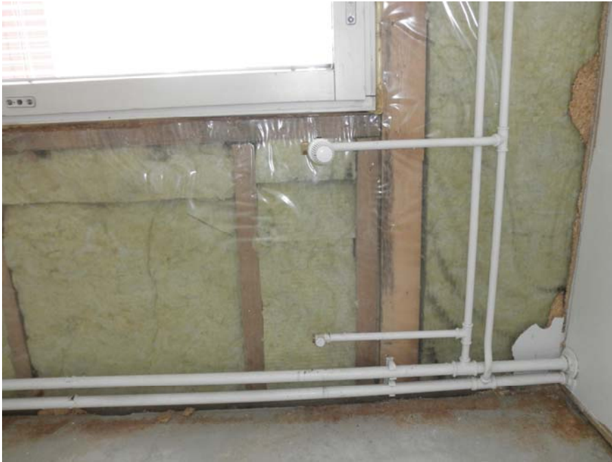
KUVA 15. Huolimattomasti asennetut lämmöneristeet
