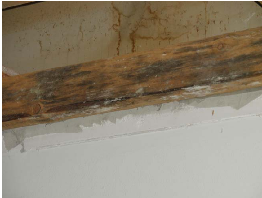
KUVA 2. Kostunut ja tummunut yläpohjan päätypalkki
