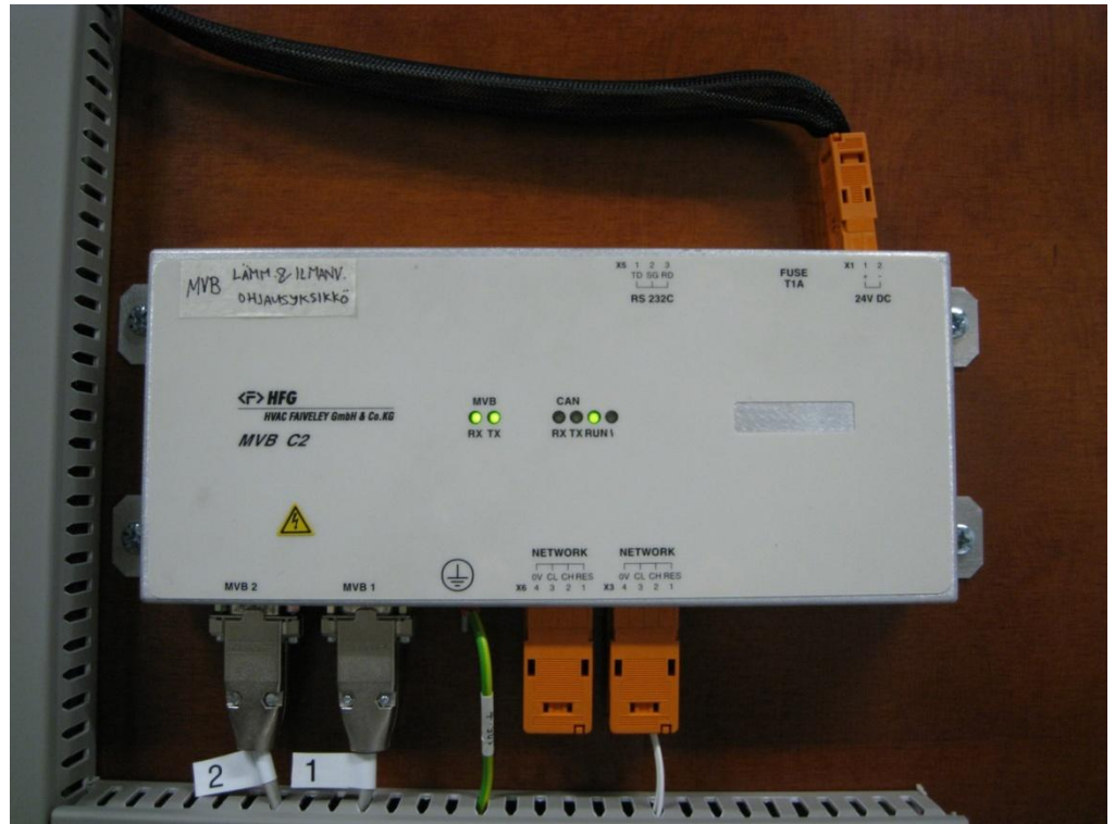
Kuva 10. Lämmitys- ja ilmanvaihtojärjestelmän vaunuväylään liittyvä ohjausyksikkö
