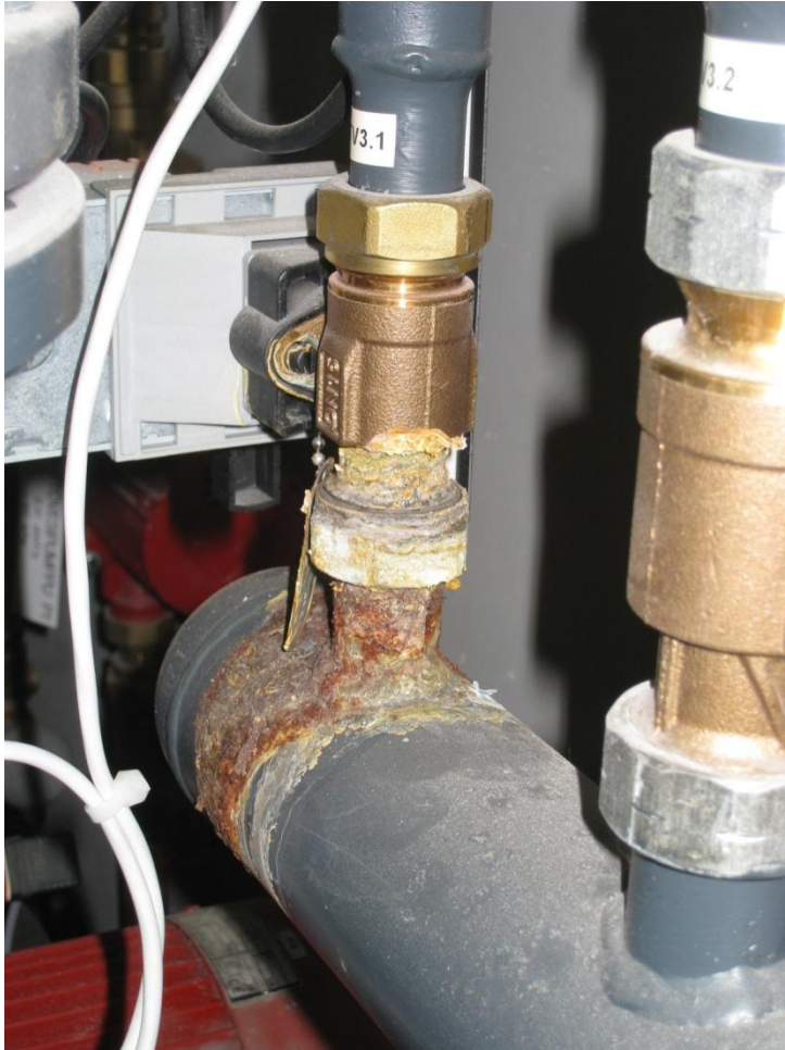
Kuva 1. Lämmönjakohuoneen IV-lämmityspiirin venttiilin vuoto
