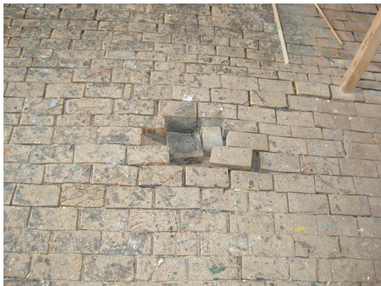
Kuva1. Teknistencyönluokassa on lattiassa reikä, joka aiheuttaa kompastumisen riskiä.
