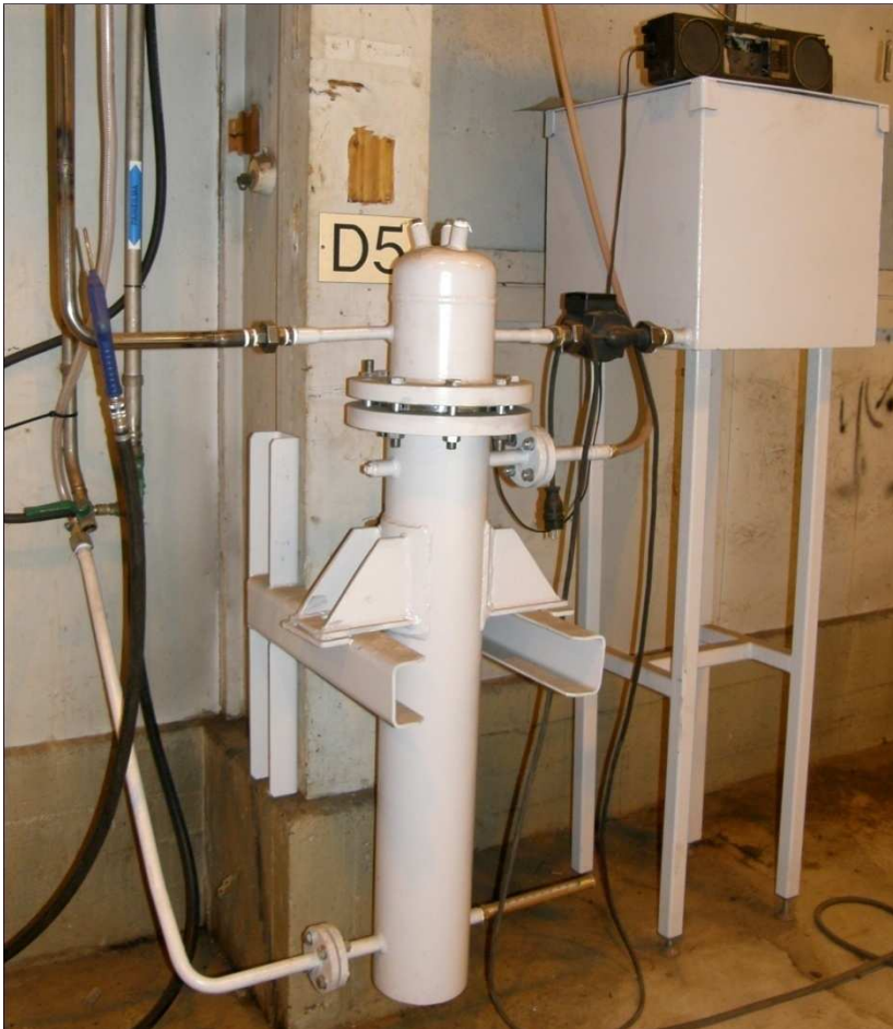
Kuva 12. Vedensuodatin, vesipumppu ja vesisäiliö.
