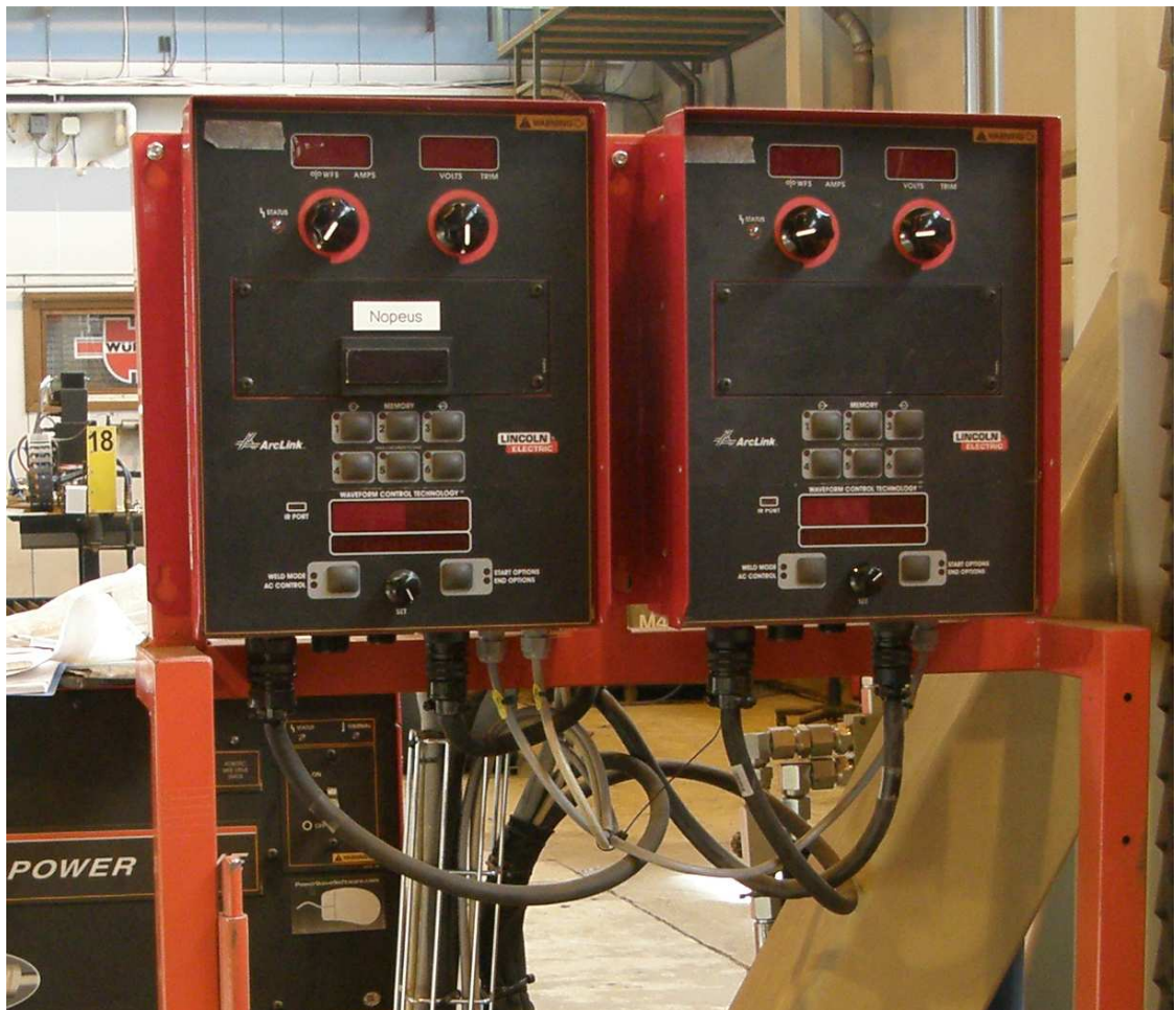
Kuva 14. Ohjauspaneelit, joista seurataan hitsausnopeutta, jännitettä ja virtaa.
