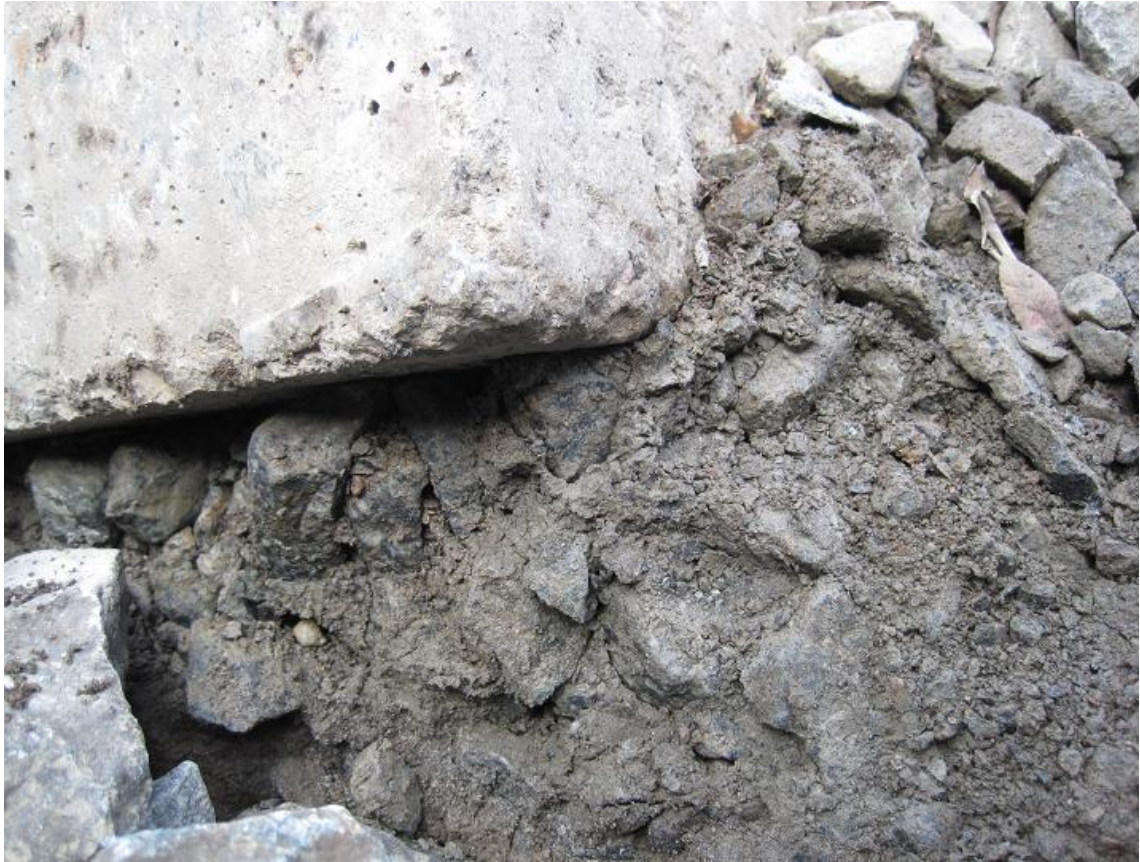
Hienontunutta sepeliä vaihteen risteyksen kohdalla
