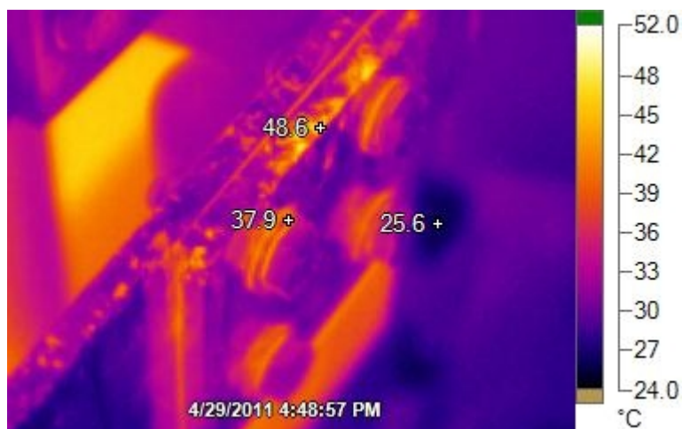
Kuva 2. Altaan 317 etupuolen puhdistettu katodikiskon liitos, jossa on selvä ilmarako toisessa laidassa. Altaan toinen puoli on kytketty irti. 1000 A (Kuva: Kalle Mononen)
