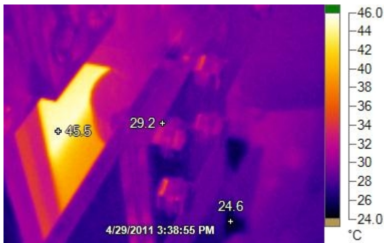
Kuva 1. Altaan 317 etupuolen katodikiskon väljä liitos. Altaan toinen puoli on kiristetty normaalisti. 500 A (Kuva: Kalle Mononen)
