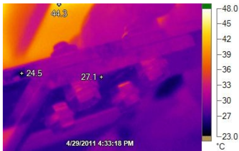
Kuva 1. Altaan 317 etupuolen puhdistettu katodikiskon väljä liitos. Altaan toinen puoli on kytketty irti. 500 A (Kuva: Kalle Mononen)
