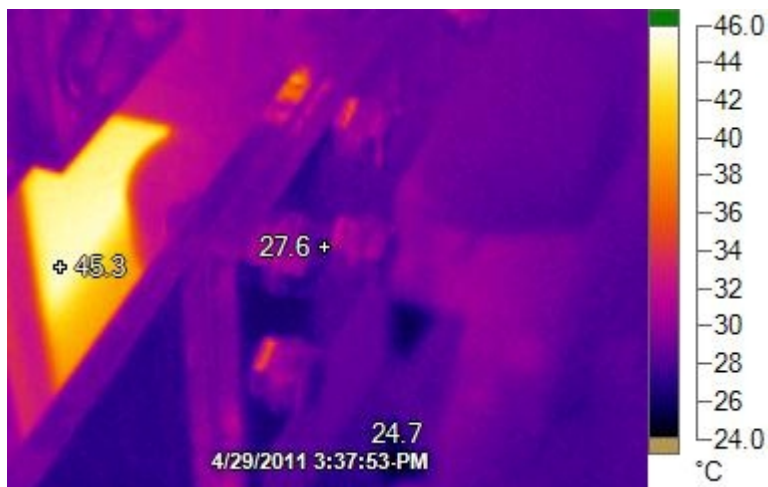
Kuva 1. Altaan 317 etupuolen katodikiskon liitos vertailukuva 1 1600 A (Kuva: Kalle Mononen)
