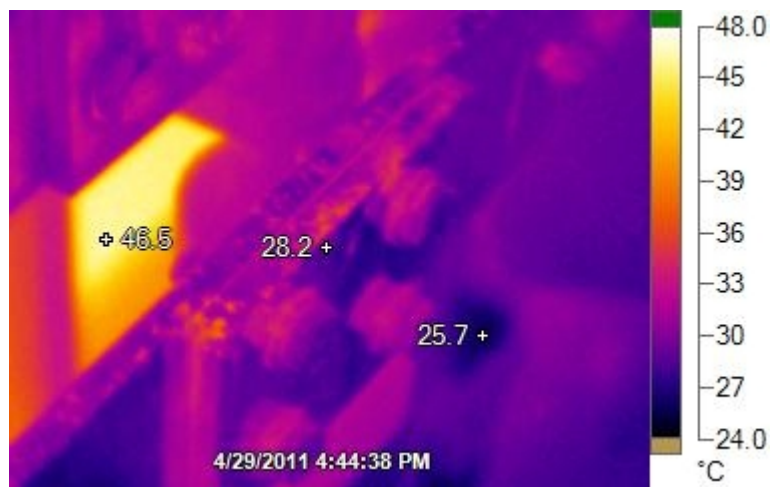
Kuva 1. Altaan 317 etupuolen puhdistettu katodikiskon liitos, jossa on selvä ilmarako toisessa laidassa. Altaan toinen puoli on kytketty irti. 500 A (Kuva: Kalle Mononen)
