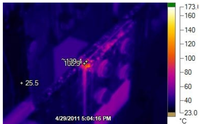
Kuva 4. Altaan 317 etupuolen puhdistettu katodikiskon liitos, jossa on selvä ilmarako toisessa laidassa. Altaan toinen puoli on kytketty irti. 1500 A (Kuva: Kalle Mononen)
