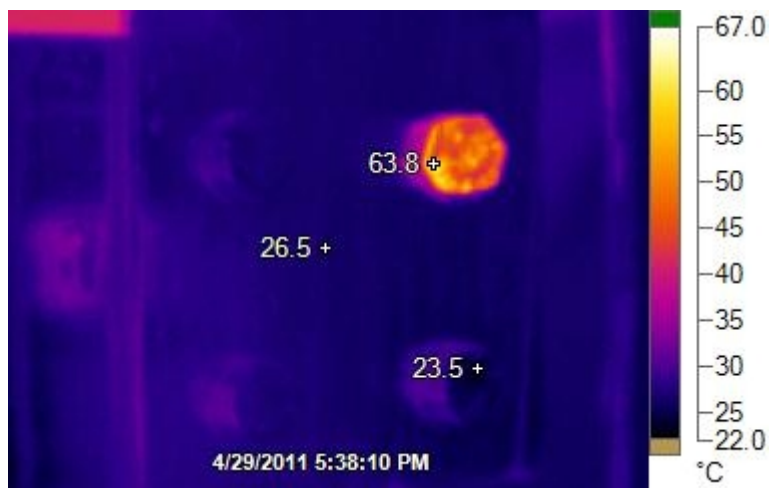
Kuva 2. Väljä liitos, jossa on yksi lämmennyt pultti. 1000 A (Kuva: Kalle Mononen)
