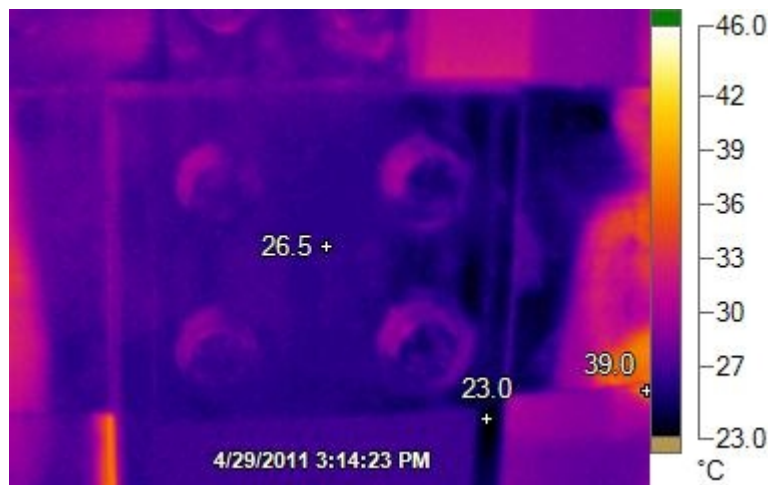
Kuva 2. Altaan 317 etupuolen katodikiskon liitos vertailukuva 2. 1600 A (Kuva: Kalle Mononen)
