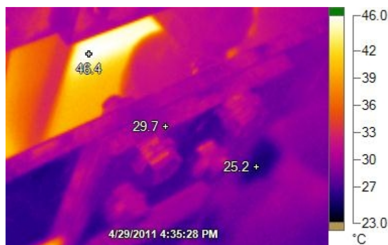
Kuva 2. Altaan 317 etupuolen puhdistettu katodikiskon väljä liitos 1000 A. Altaan toinen puoli on kytketty irti. 1000 A (Kuva: Kalle Mononen)
