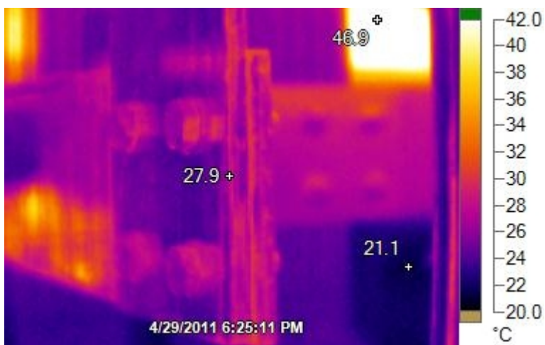
Kuva 2. Hapettunut liitos kiristettynä normaalisti. Altaan toisen puolen liitos on kytketty irti. 1600 A (Kuva: Kalle Mononen)
