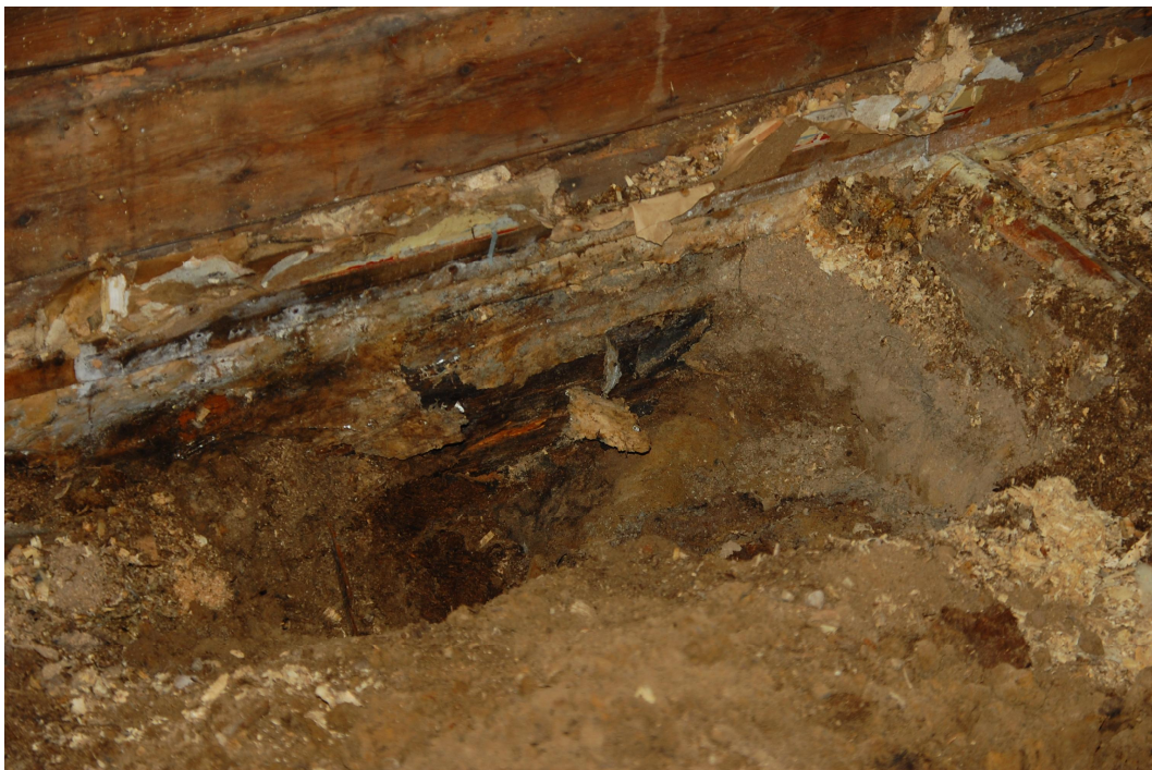
Kuva 3. Seinä kuvattuna edellisen kuvan kohdalta sisäpuolelta.
