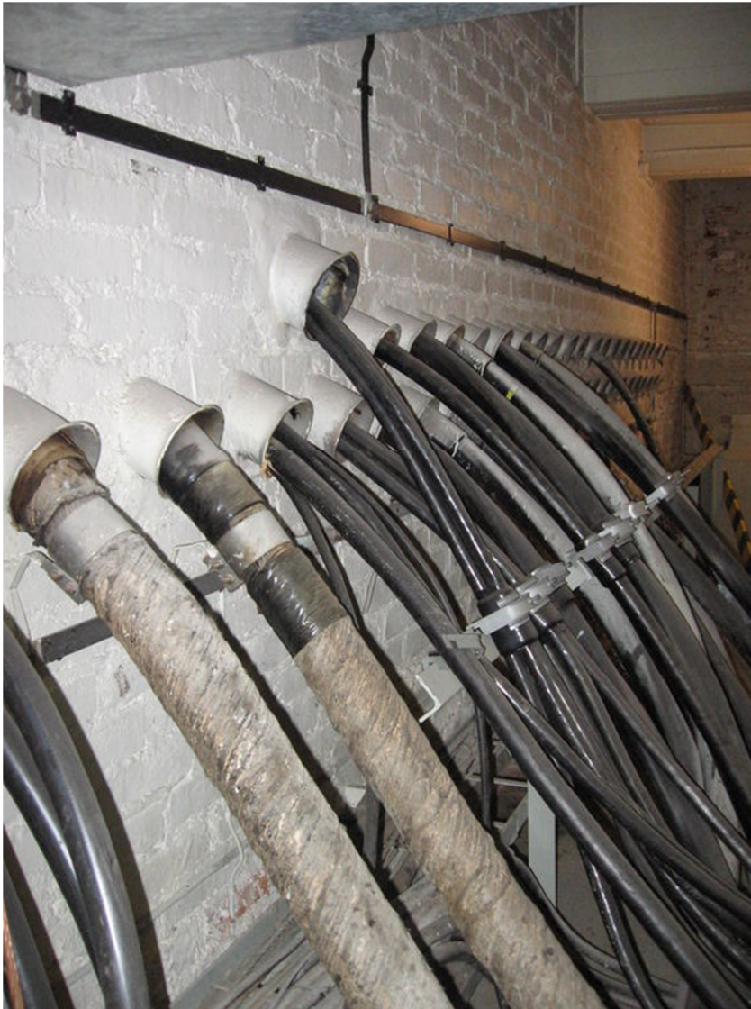
Kuva 6. Keskijännitekaapeleiden lähdöt kaapelikellarista.
