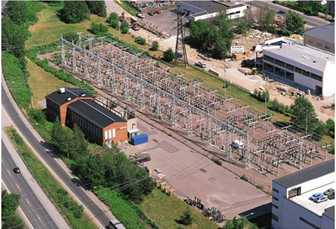
Kuva 11. Herttoniemen sähköaseman suurehko avokytinkenttä.
