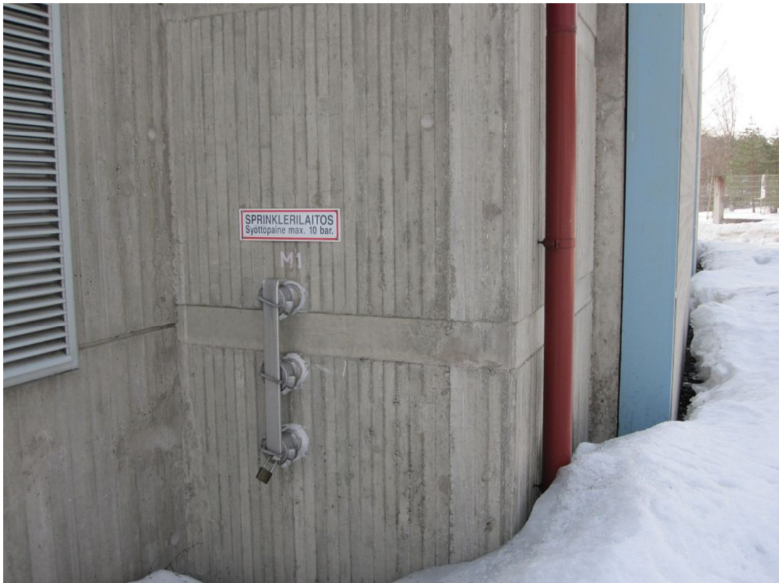
Kuva 10. Kuivasprinklausjärjestelmän liittimet muuntajabunkkerin kyljessä.
