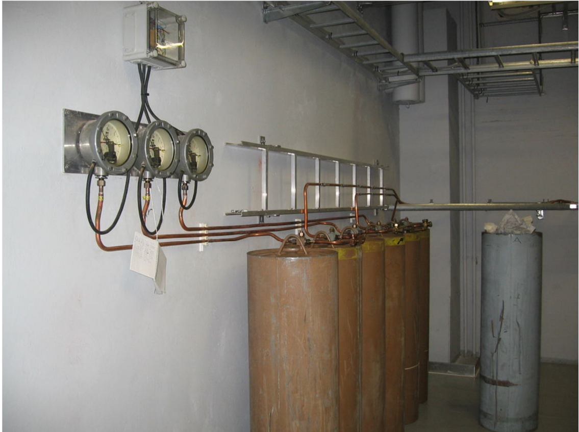
Kuva 2. Siirtoverkon öljyeristeisten kaapeleiden öljysäiliöt.
