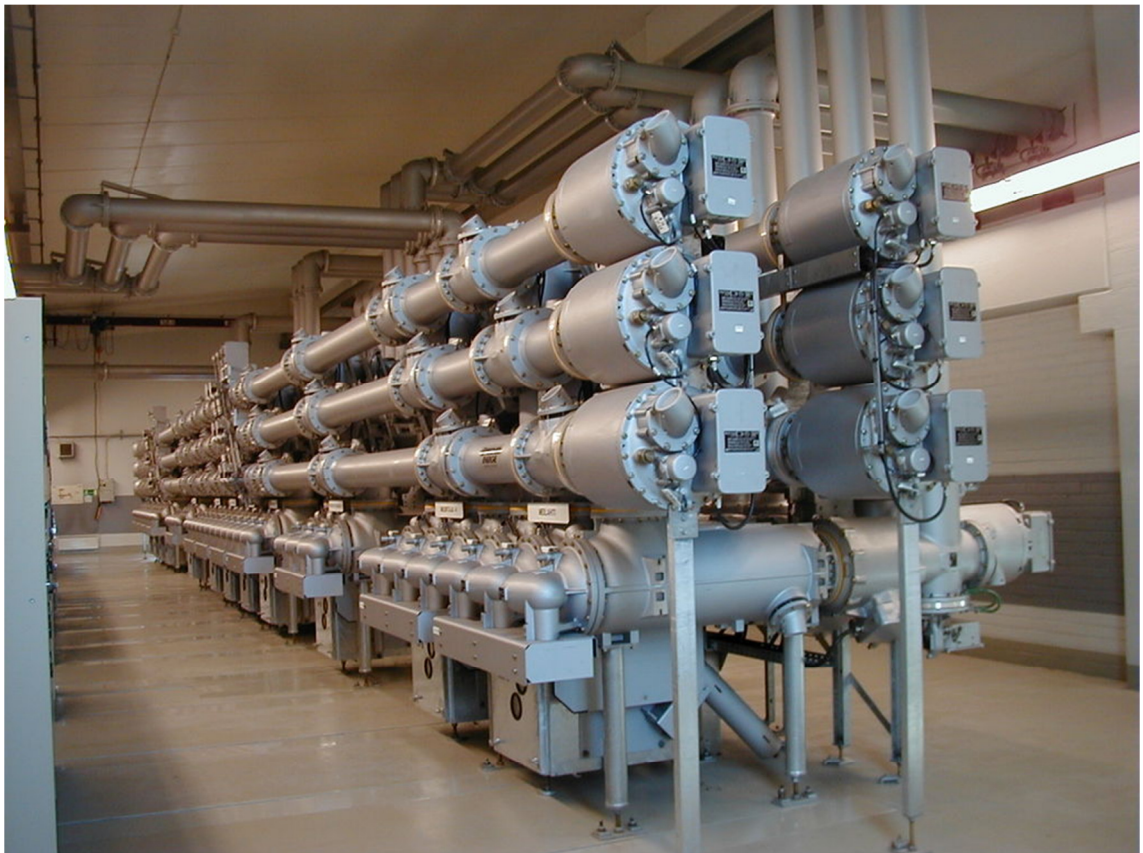
Kuva 7. Yksi suurimmista HSV:n 110 kV:n GIS-kojeistoista.
