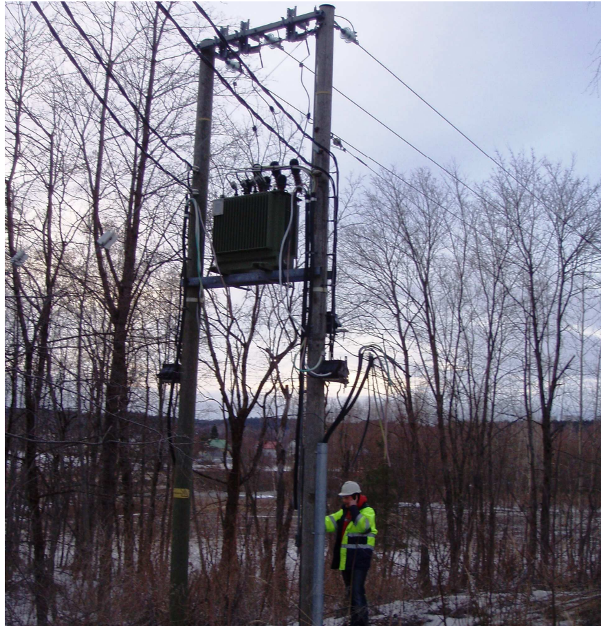
Kuva 4. Asentaja soittaa käyttökeskukseen 20 kV:n muuntajaerottimen avaamisesta.
