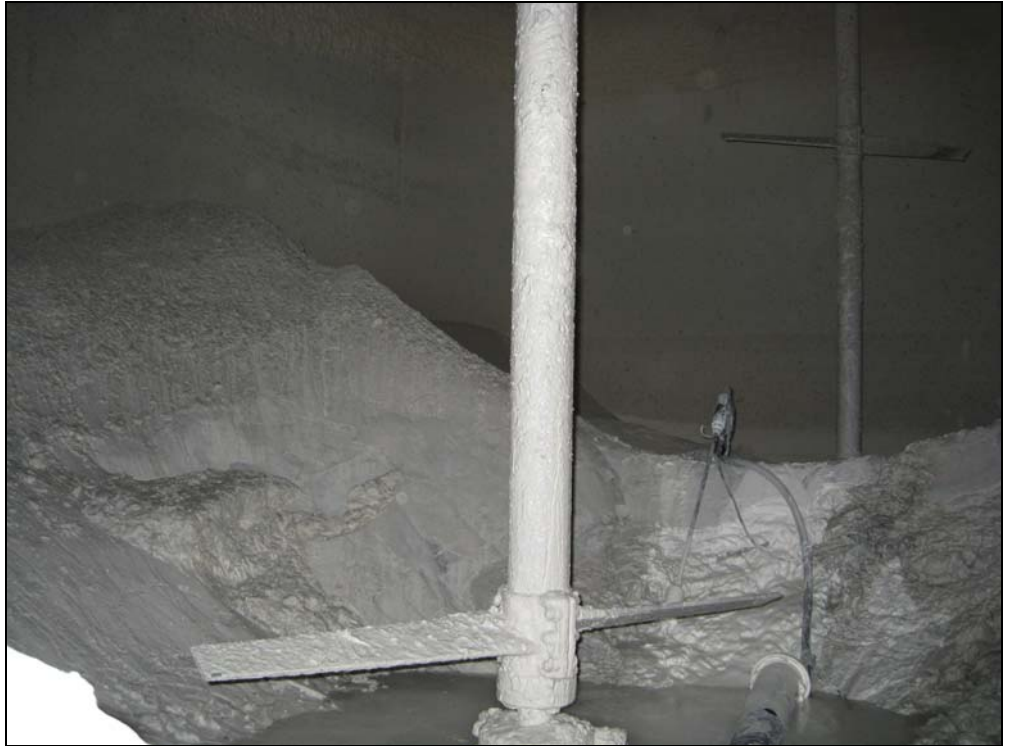
Kuva 6. Kalkkikertymiä varastosäiliössä vuosihuollossa 2008
