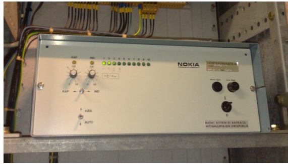
Kuva 11. Isoverin TAG-keskuksen loistehosäätäjäyksikkö
