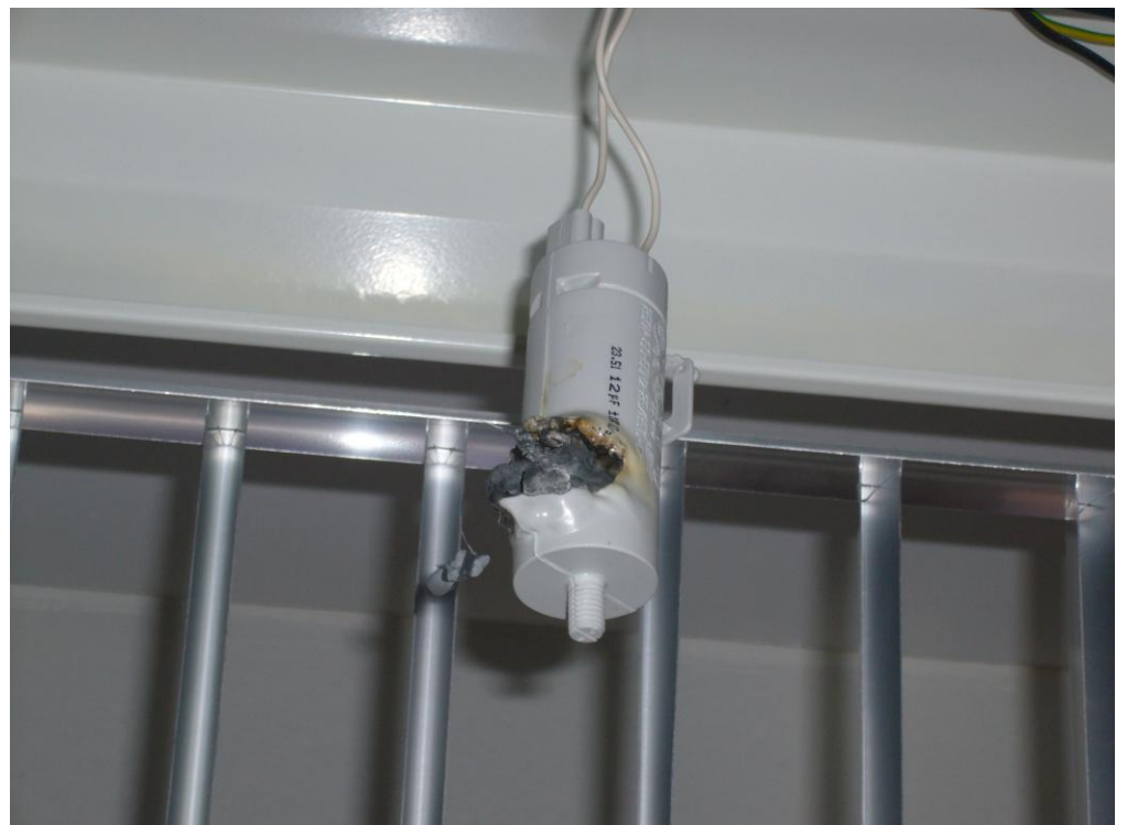
Kuva 10. Nykyisestä järjestelmästä huonokuntoinen kompensointikondensaattori
