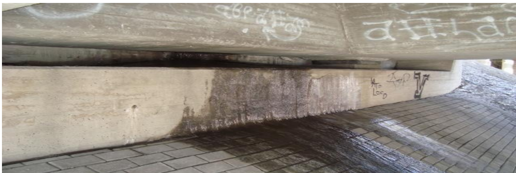
KUVA 3: Liikuntasauoman kumitiivisteen vauriosta vesi valuu sillankannen alapuolisille rakenteille (Kuva: Joonas Kilpinen 2011)
